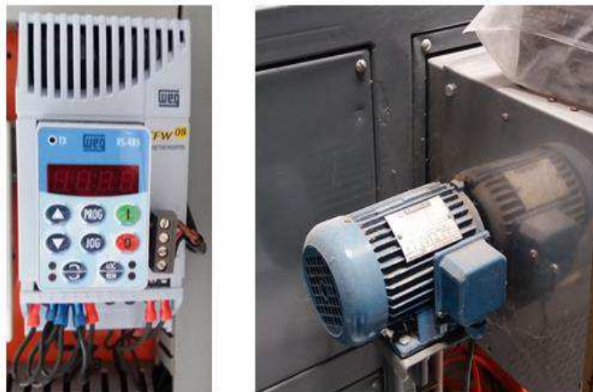
Figura 3.29 Sistema de controle da velocidade do ar de secagem do secador elétrico
