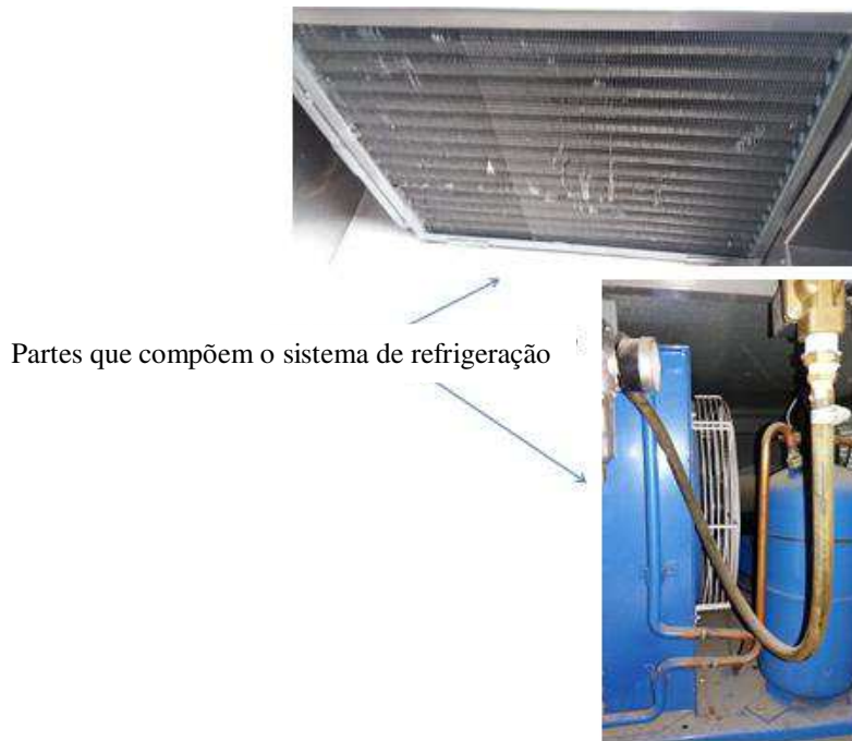
Figura 3.23 Sistema de refrigeração do secador elétrico.
