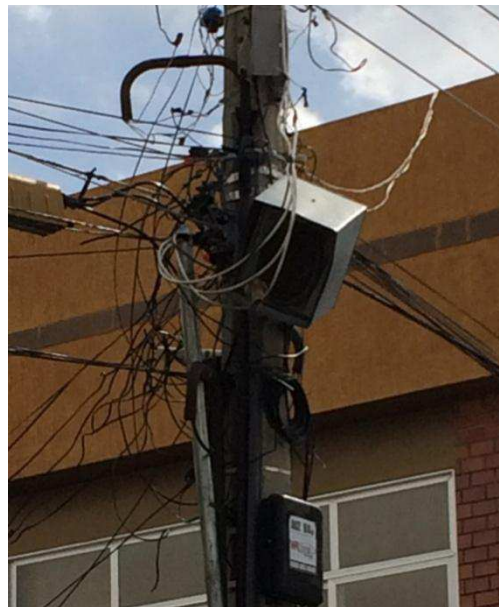
Imagem 11: Imagem das caixas de som instaladas em poste no centro da cidade de Pombal, este sistema pertencente a Rádio Comunitária 104 FM, localizado próximo a Praça Getúlio Vargas. Imagem capturada no dia 13 de março de 2017.
