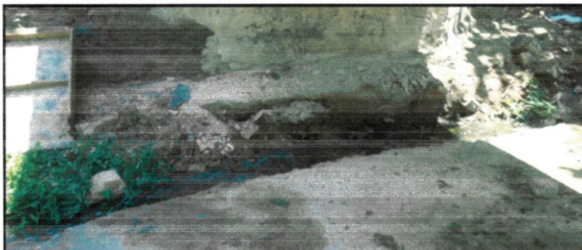
Figura 11. Coleta de efluentes (esgoto mais contribuição pluvial)
