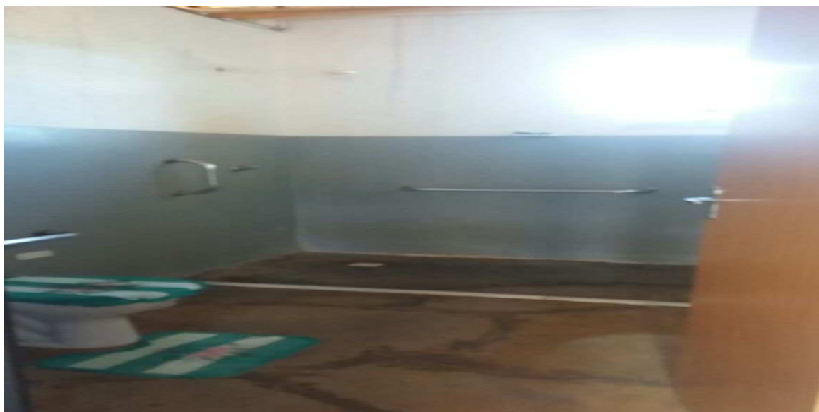
Figura 12 - Banheiro de uma das casas da vila.
