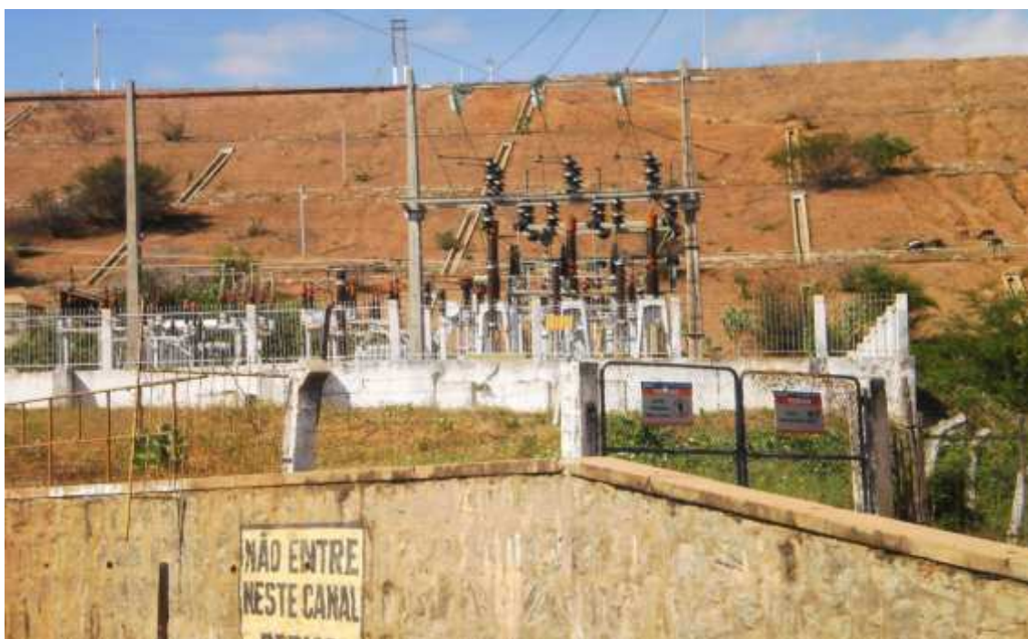
Figura 10: Usina hidrelétrica curema.
