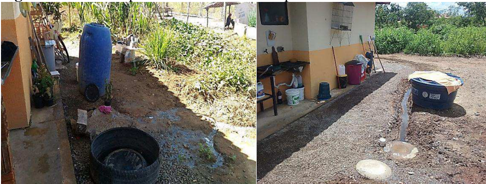
Figura 5 - Fossas sépticas construídas muito próximas às casas
