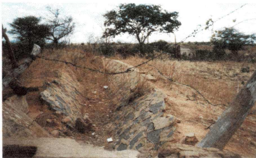
Figura 4.26. Estruturas de irrigação inutilizadas pela falta de manutenção. Comunidade Massapê. S 6°47'42" W 38°16'28"
