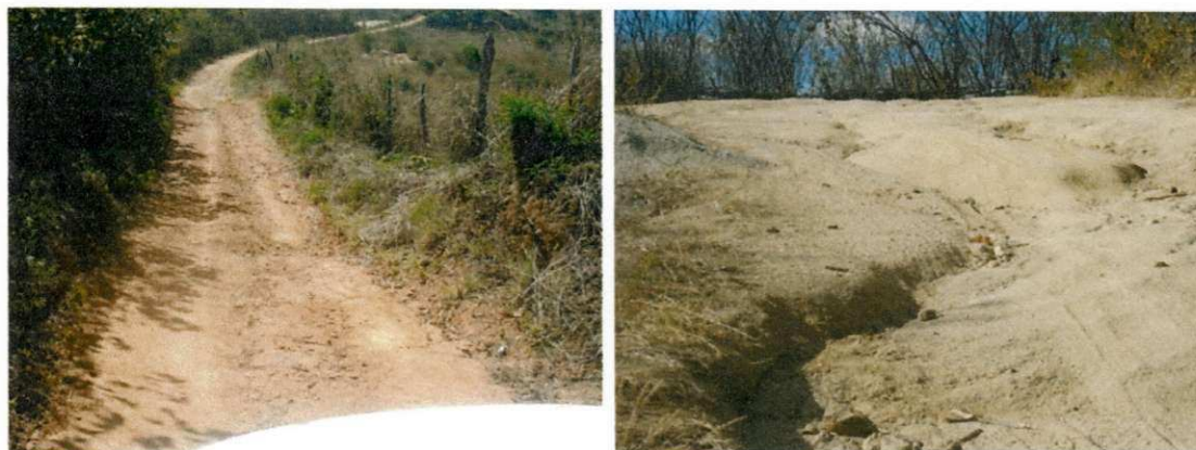
Figura 52. Evidências da falta de manutenção na malha viária da bacia hidrográfica do açude Cachoeira dos Alves.
