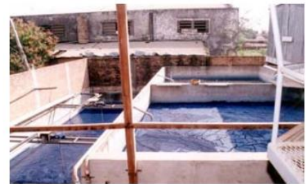
Estação de tratamento de efluentes
