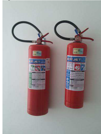
Figura 25 - Extintores do Bloco1
