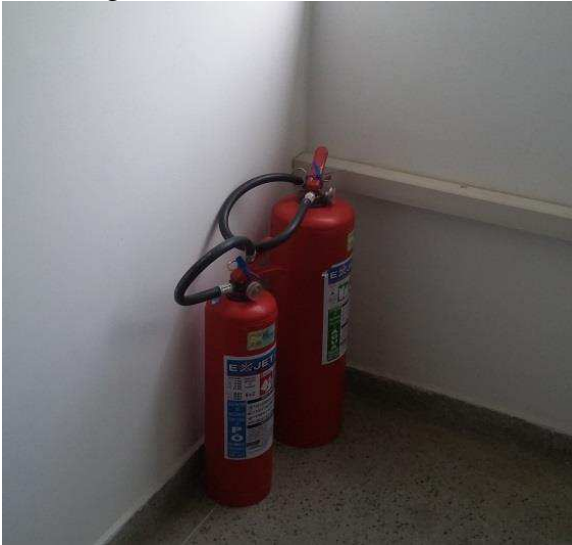
Figura 24 - Extintores do Bloco2
