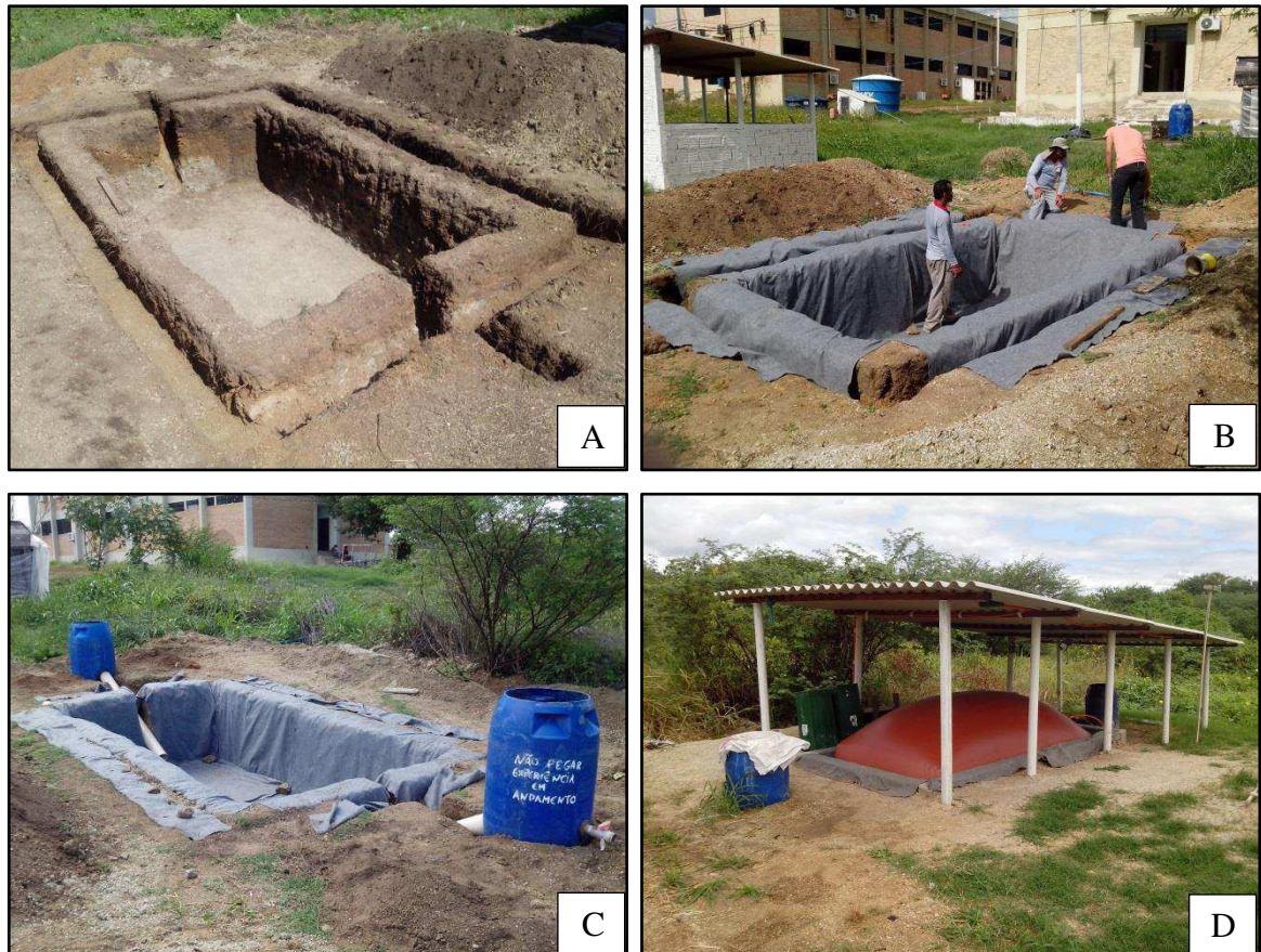
Figura 7 - Detalhe da montagem do biodigestor. A-Preparação do solo para instalação do biodigestor, B-Instalação da Manta Bidim, C-Instalação das caixas de entrada e saída do biodigestor, D-Biodigestor instalado.
