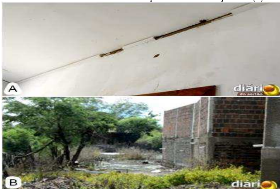
Figura 2 - Rachaduras nas residências (A) e alagamento causado pelas chuvas em terrenos em torno do Açude Grande de Cajazeiras (B).
