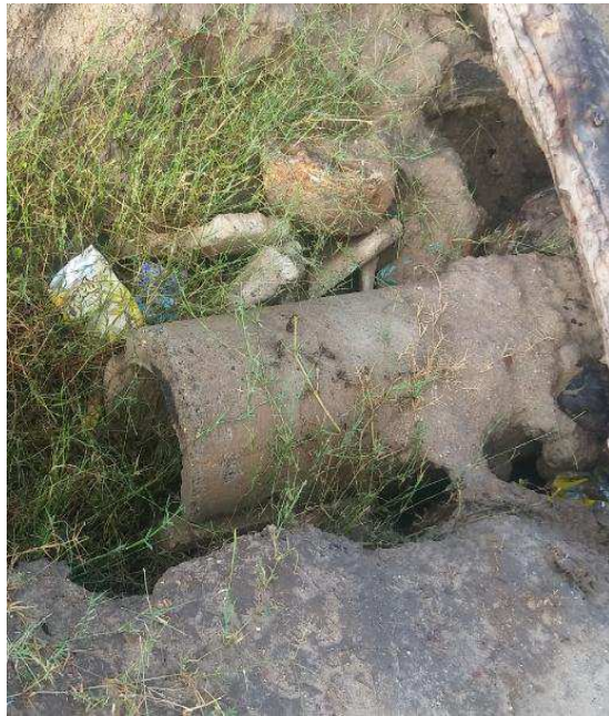
Figura 10 - Tubulação de esgoto
