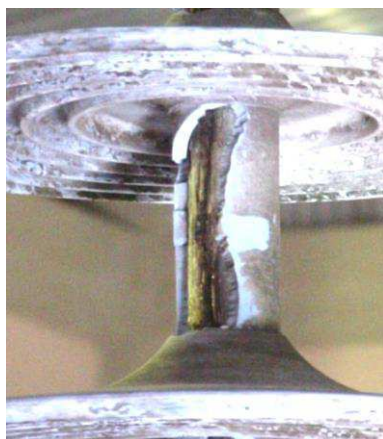
Figura 2.6 - Trilhamento do núcleo em isolador polimérico.
