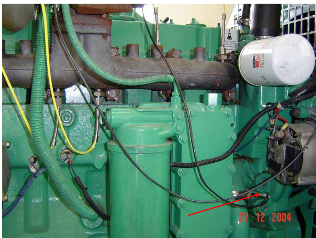
Figura 3.14 - Termopar instalado para medição da temperatura da água na entrada do motor.
