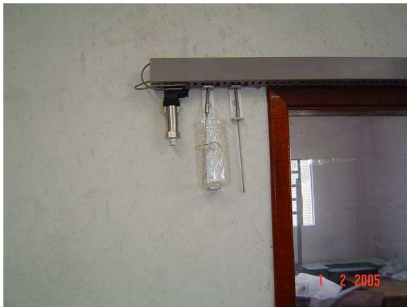
Figura 3.15 – Sistema de medição da condição atmosférica local.
