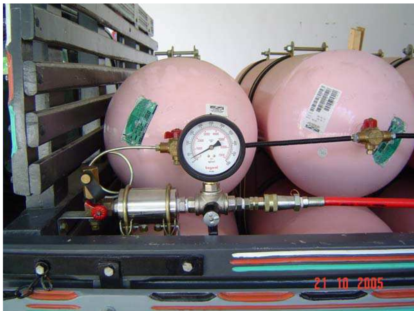
Figura 3.23 – Sistema de armazenagem de gás.
