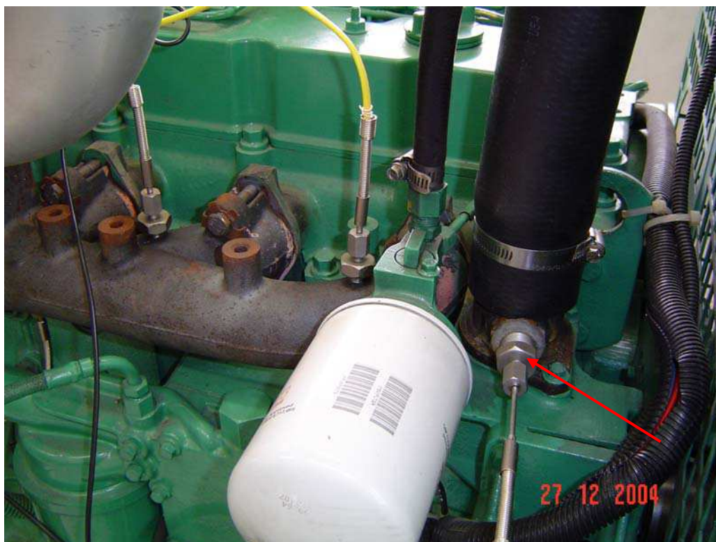
Figura 3.13 – Termopar instalado para medição da temperatura da água na saída do motor.
