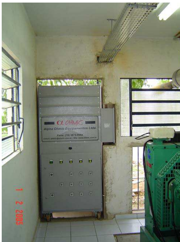
Figura 3.22 - Banco de carga de 150 kW.
