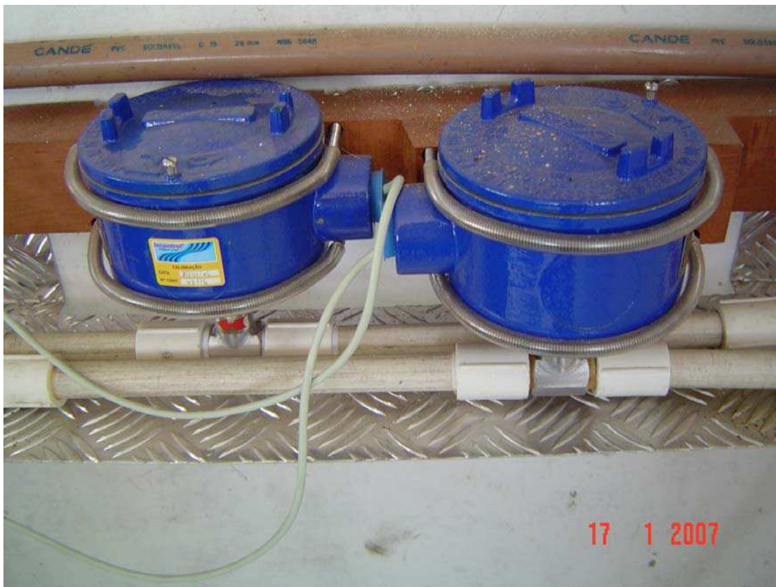
Figura 3.6 - Conjunto de medidores de vazão de óleo diesel.
