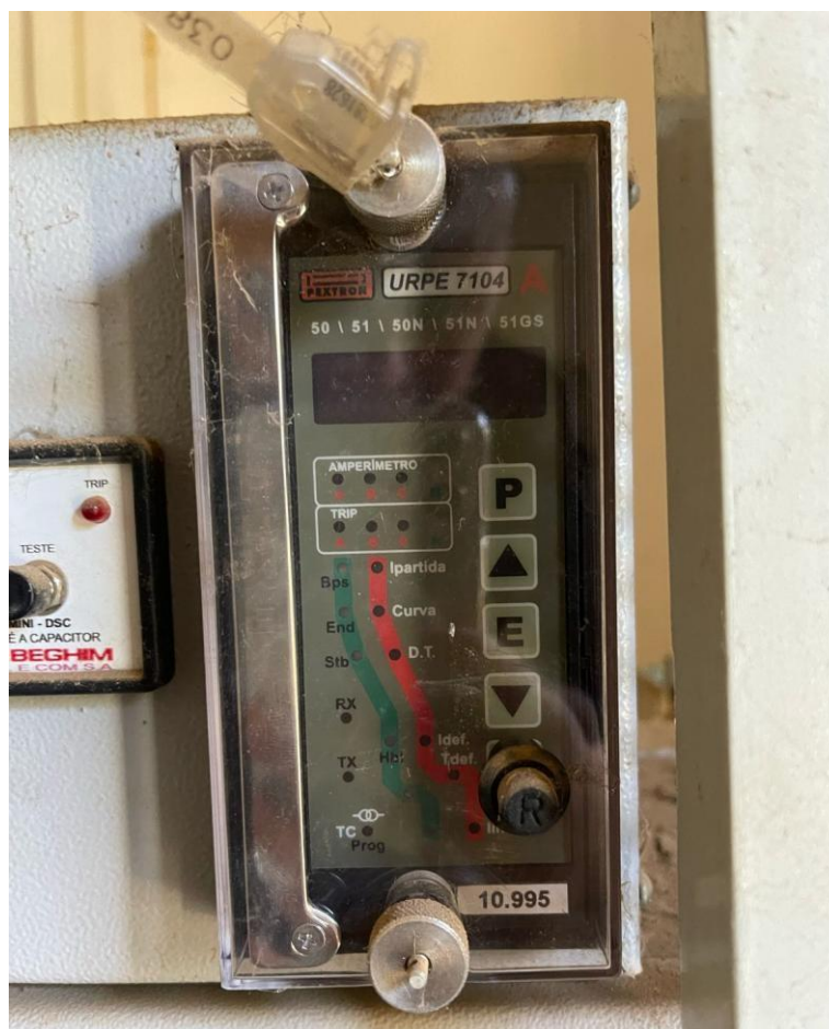
Figura 49: Relé de Proteção da malha elétrica do CFP.
