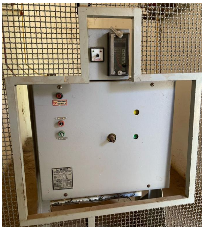
Figura 48: Disjuntor de Média Tensão do cubículo.
