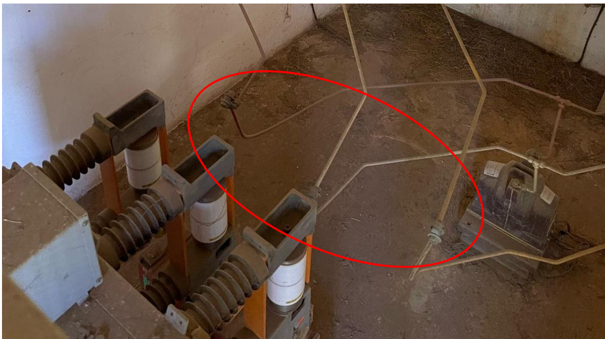
Figura 50: Bypass do Relé de Proteção.
