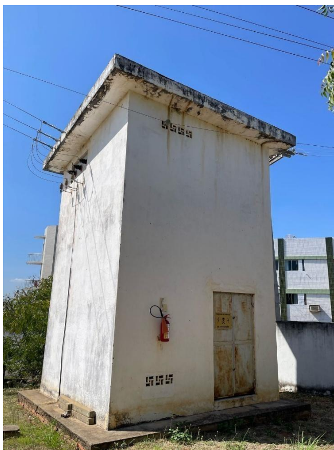
Figura 47: Cubículo de Medição e Proteção do CFP.
