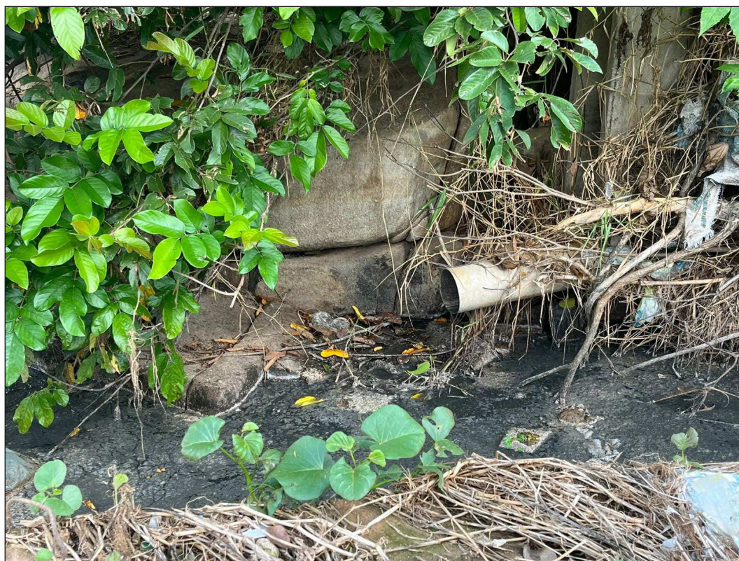
Figura 6.16 Lançamento inadequado de efluente. Fonte: Secretaria de Meio Ambiente do Município de Serra Branca.
