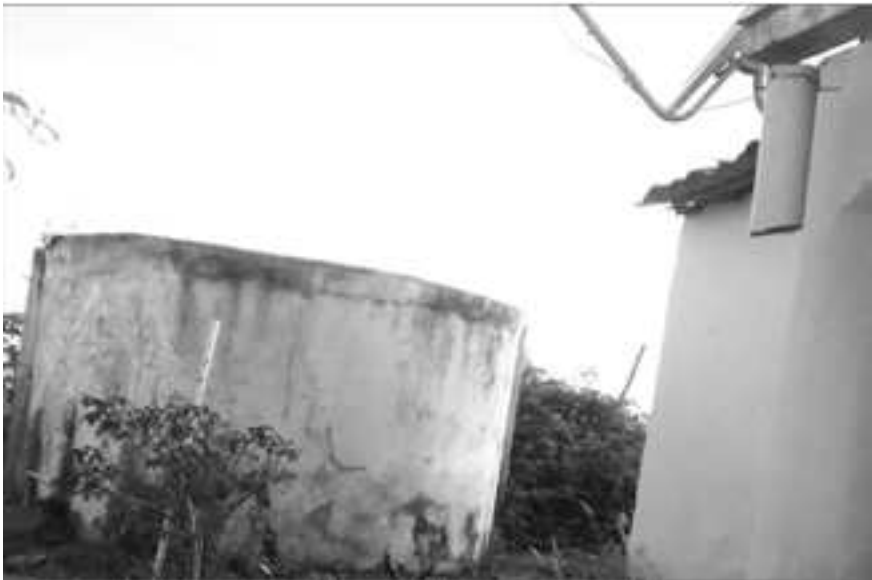
Figura 5. Cisterna abastecida pela Operação Carro-Pipa, localizada no Sítio Angiquinho, sem a calha de coleta de águas da chuva
