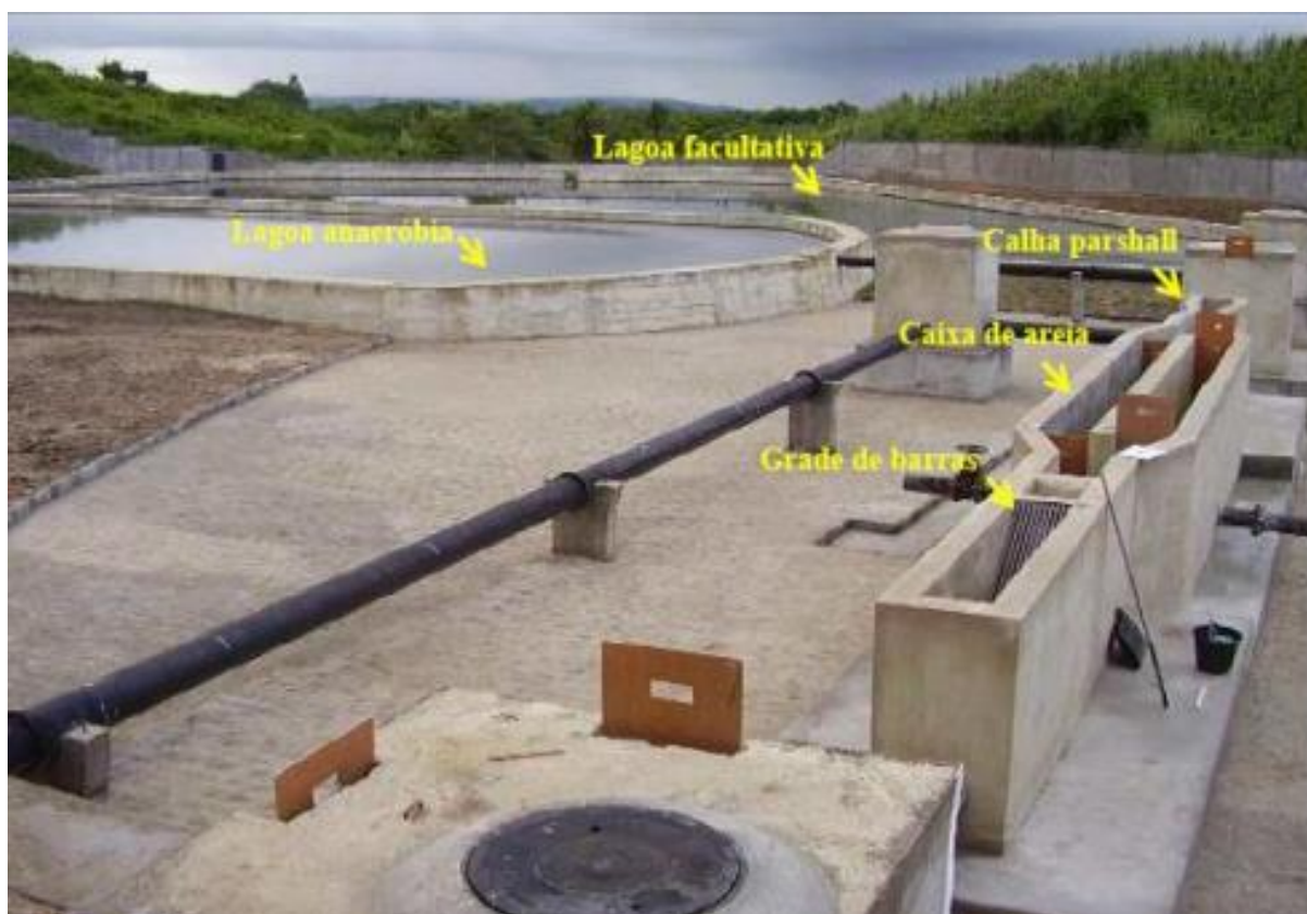
Figura 9- Vista das unidades de tratamento da ETE do Glória
