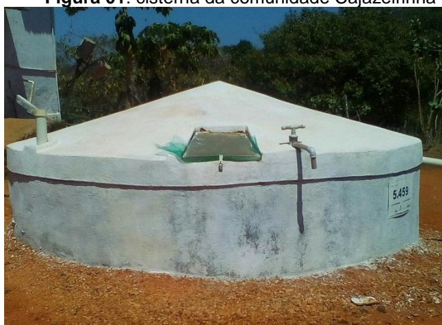
Figura 01: cisterna da comunidade Cajazeirinha
