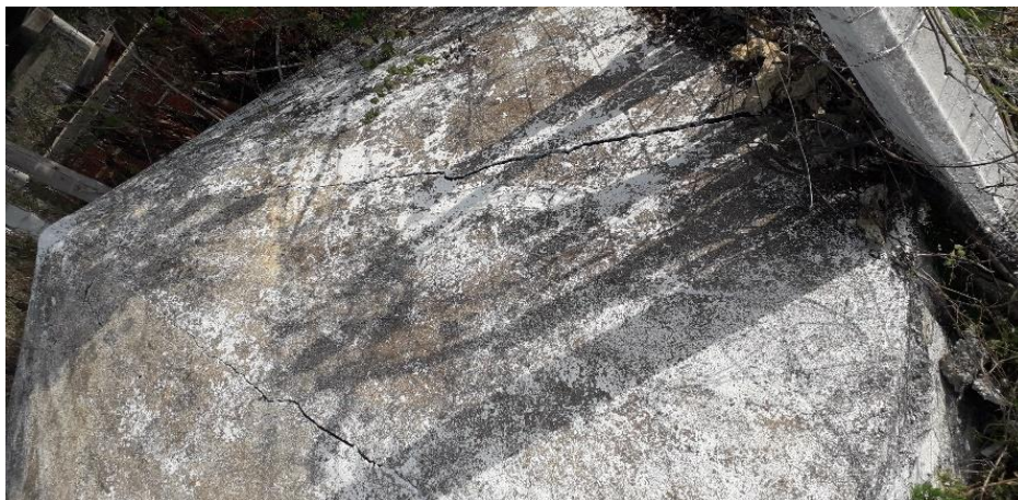
Figura 4: Cisternas danificadas. Fonte: Próprio autor, (2019)
