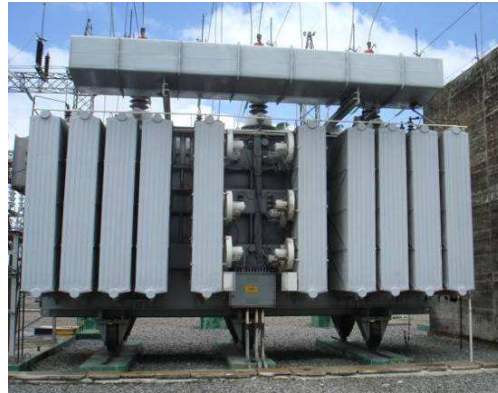
Figura 2.3 Transformador de potência
