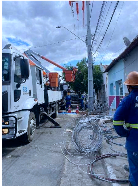
Figura 16 – Instalação de um religador automático
