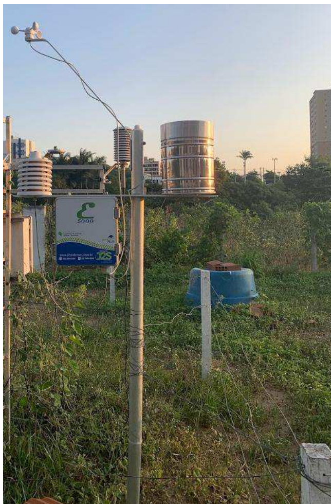
Figura 2. Estação Meteorológica instalada na área experimental
