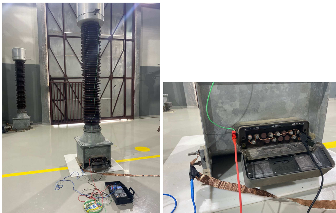
(a). Vista Ampliada do Ensaio Primário-Secundários-Terra. (b). Vista Aproximada do Ensaio Primário-Secundários-Terra.
