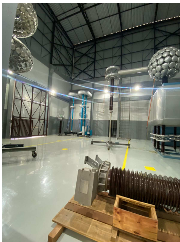
Figura 3 – Salão de Alta Tensão (SAT).
