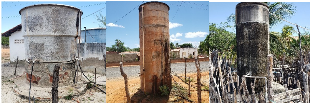
Figura 13 – Estado de conservação das estruturas de reservação – Cantinho
