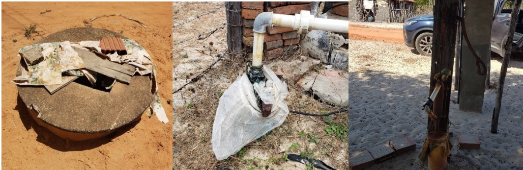
Figura 11 – Estado de conservação das bombas de captação – Cantinho
