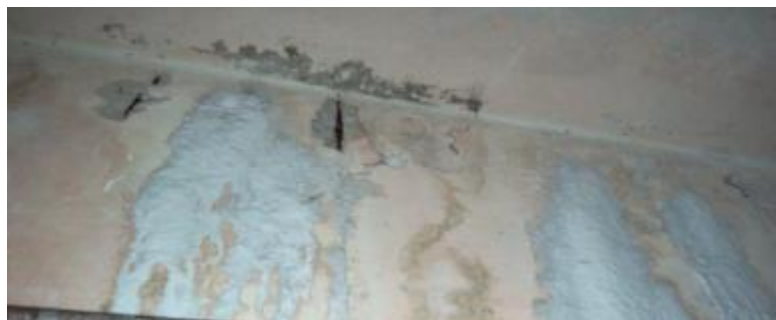
Figura 4 – Eflorescência na superfície de paredes com pintura
