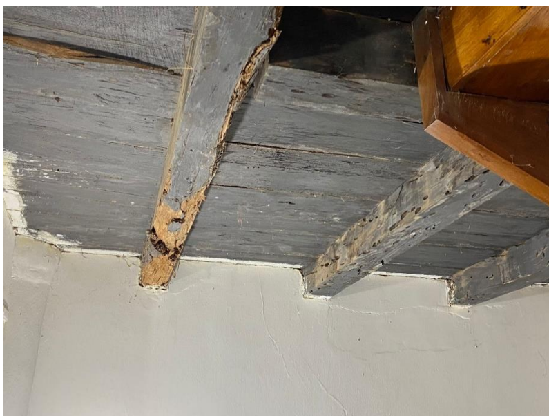
Figura 6 – Desgaste na parte inferior do piso de madeira da edificação em estudo
