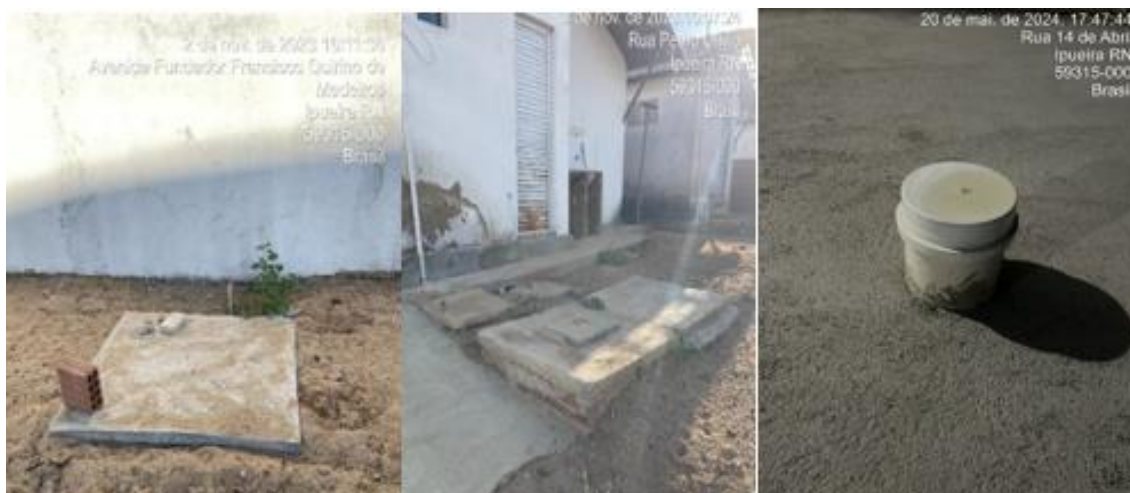
Figura 5: Uso de fossas negras em residências.
