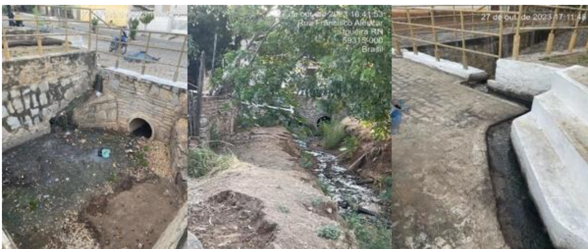
Figura 16: Lançamento de efluente nas galerias de água pluvial.
