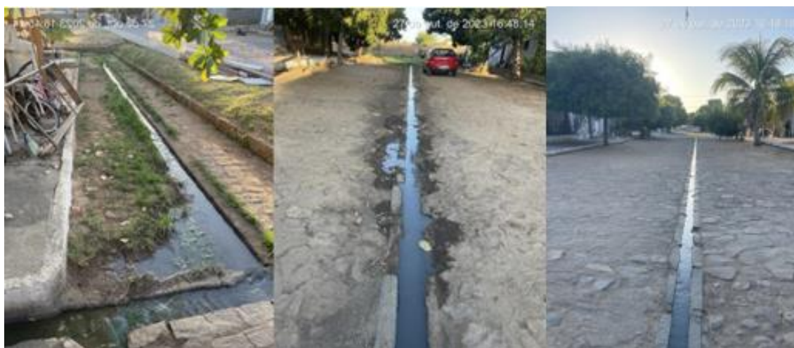
Figura 13: Lançamento de efluente a céu aberto.
