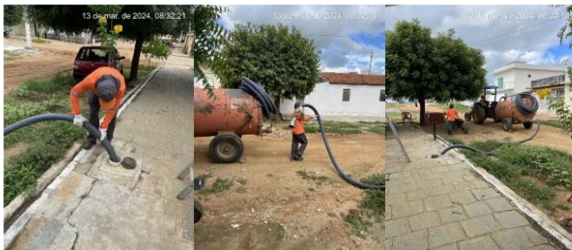
Figura 19: Registro do esgotamento de fossas negras na cidade de Ipueira-RN.
