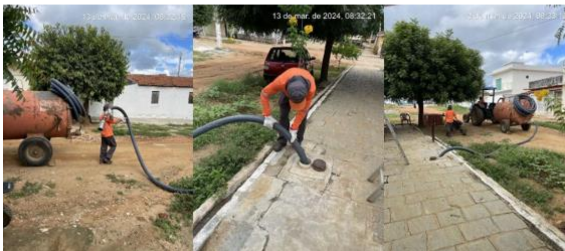
Figura 7: Trabalhadores coletando o efluente das fossas negras.
