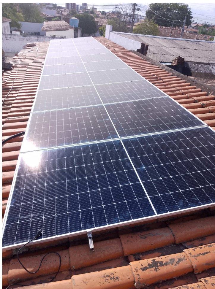
Figura 11 – Instalação fotovoltaica 11 módulos
