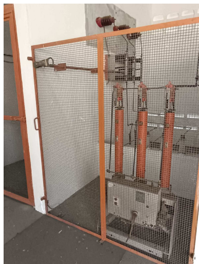
Figura 18 – Disjuntor de MT a óleo
