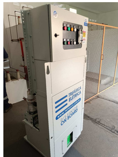
Figura 19 – Disjuntor de MT a vácuo
