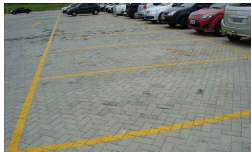
Figura 29: Piso permeável em estacionamento.
