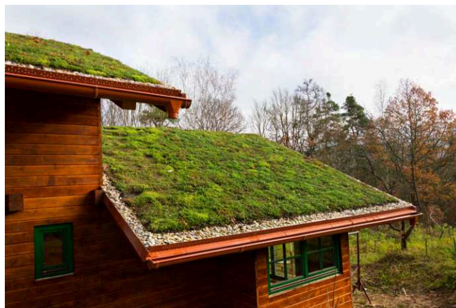
Figura 31: Exemplo de aplicação de telhado verde.
