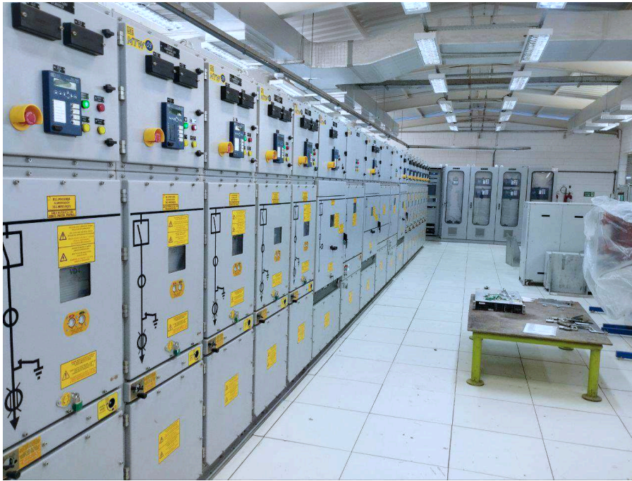
Figura 17 – Sala de painéis da Subestação Transformação
