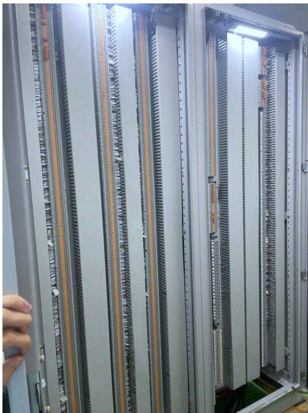
Figura 13 – Régua de bornes do painel do bay de transferência.
