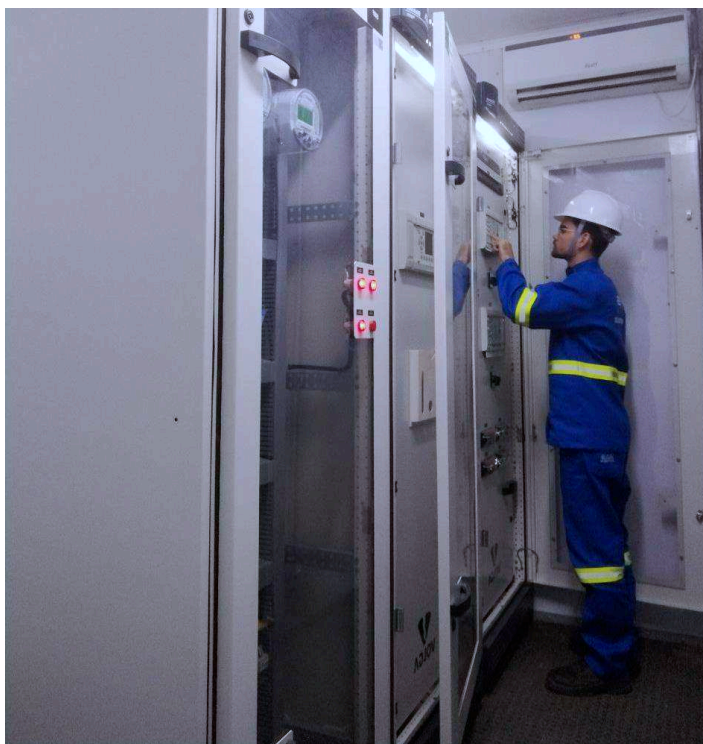
Figura 20 – Contato com o relé MICOM P145 para identificação de alarmes.
