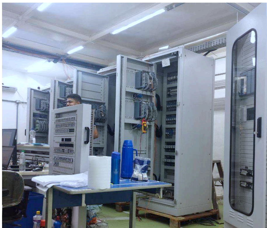
Figura 6 – Sala de testes com painéis do Transformador, Trafo-Terra e Delta
