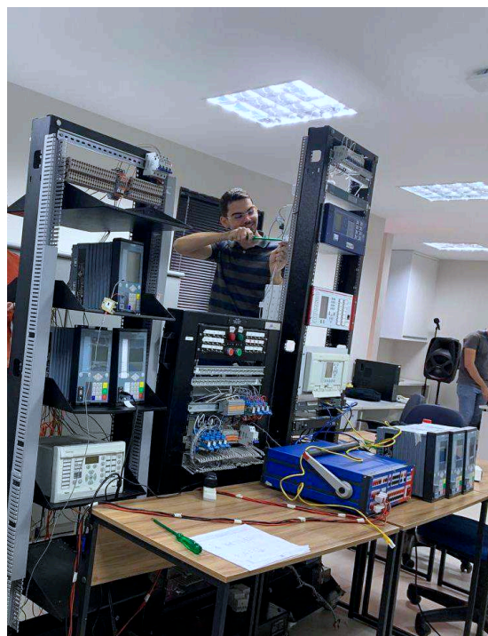
Figura 23 – Conexão do relé de teste na bancada do laboratório da ESC.
