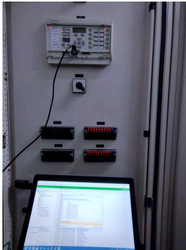
Figura 21 – Conexão com relé MICOM P145 via cabo serial.
