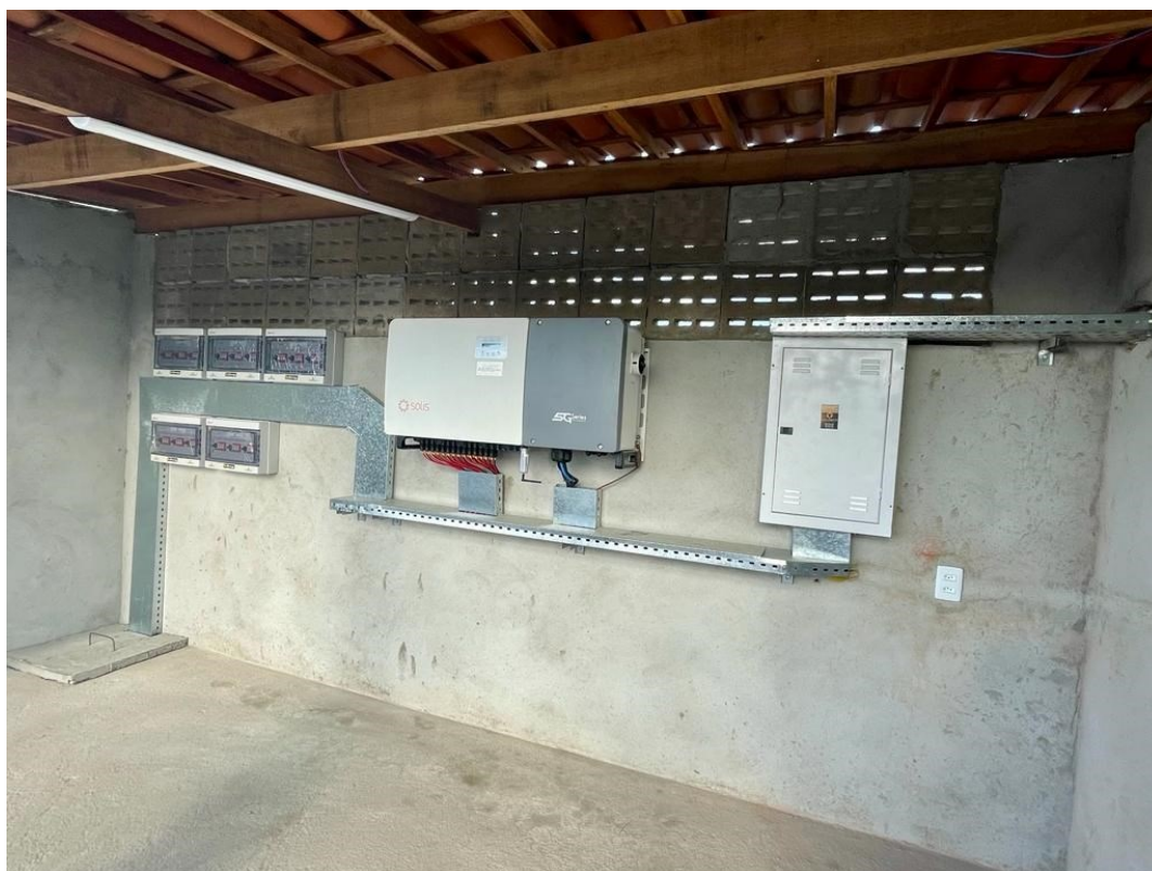
Figura 47: Abrigo do Inversor Concluído.
