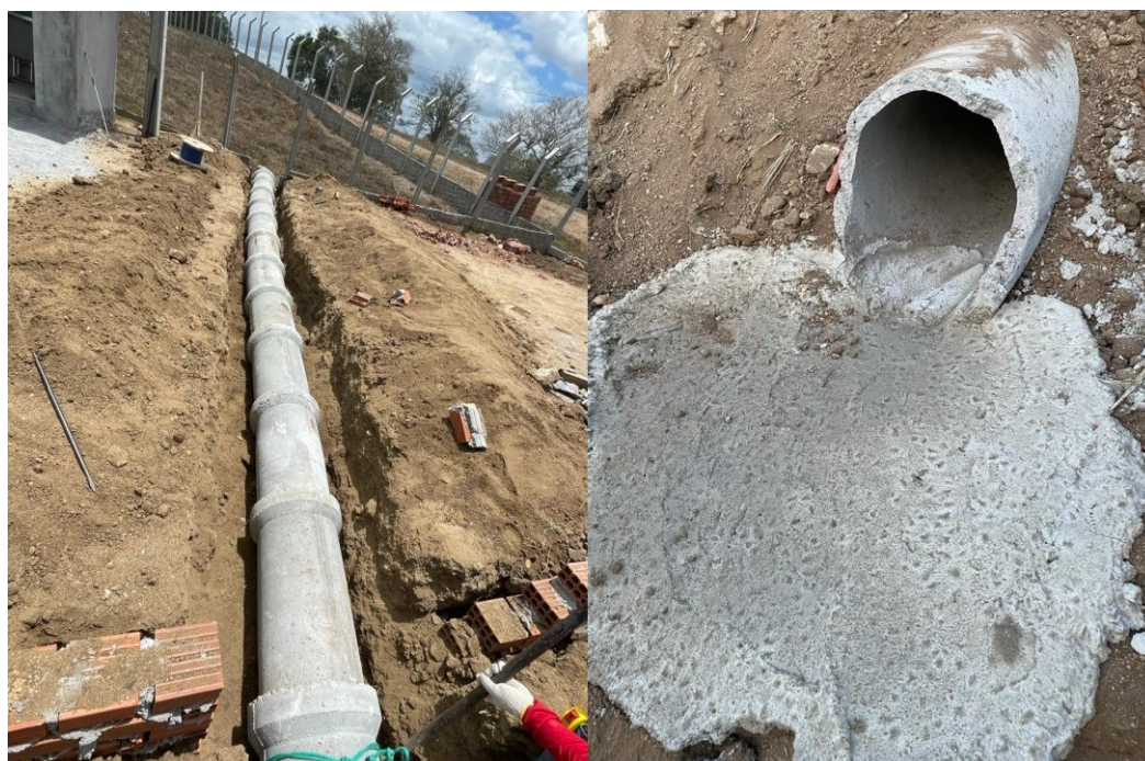
Figura 30: Manilhas para Passagem do Maior Fluxo de Água.
