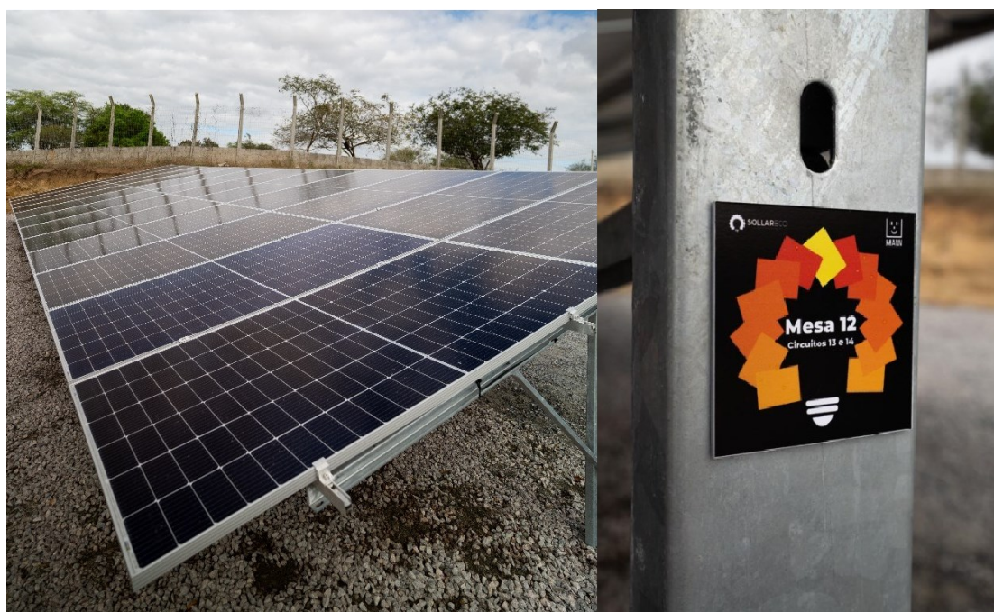
Figura 49: Detalhes da Usina.
