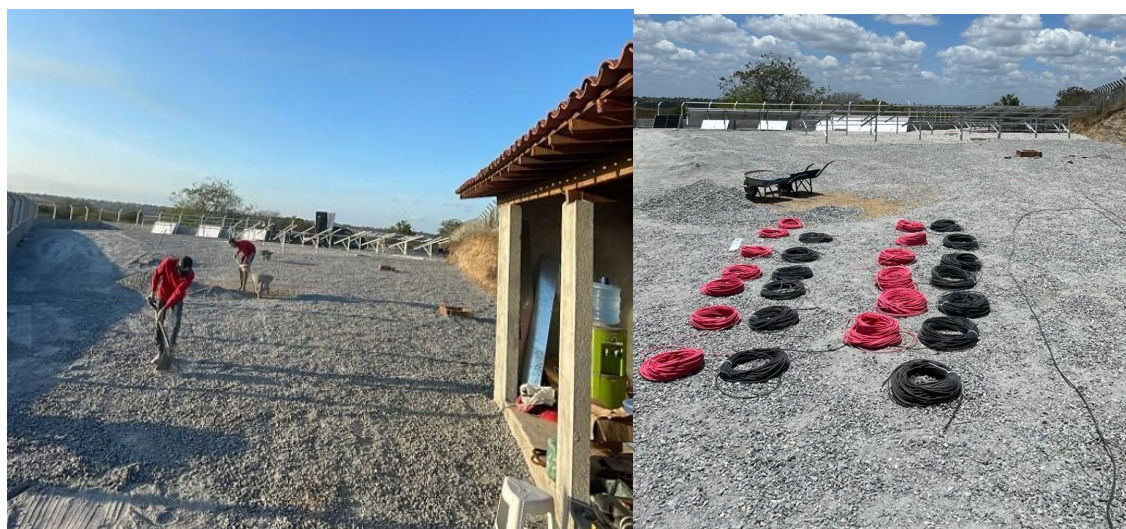
Figura 40: Separação do cabeamento CC das Strings .
