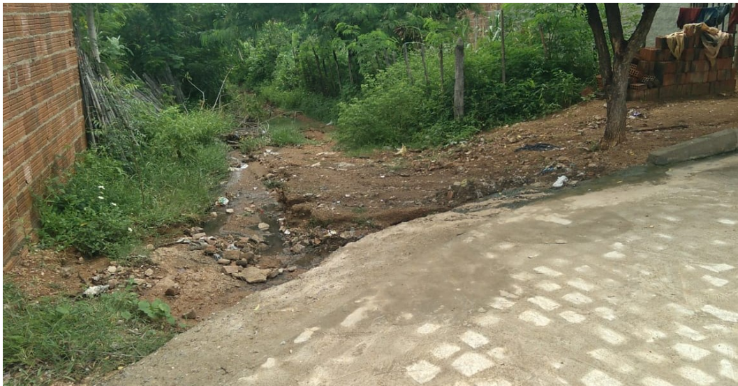
Foto 16 - Esgotos às margens do açude
