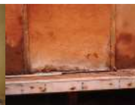
Infiltração de água
