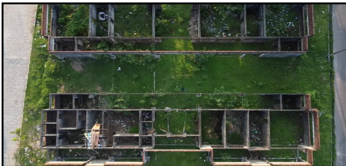
Bayeux (Mata Paraibana), Creche Tipo B, conveniada há 10 anos. Situação: com 51% de execução, foi abandonada. conveniada há 10 anos.
