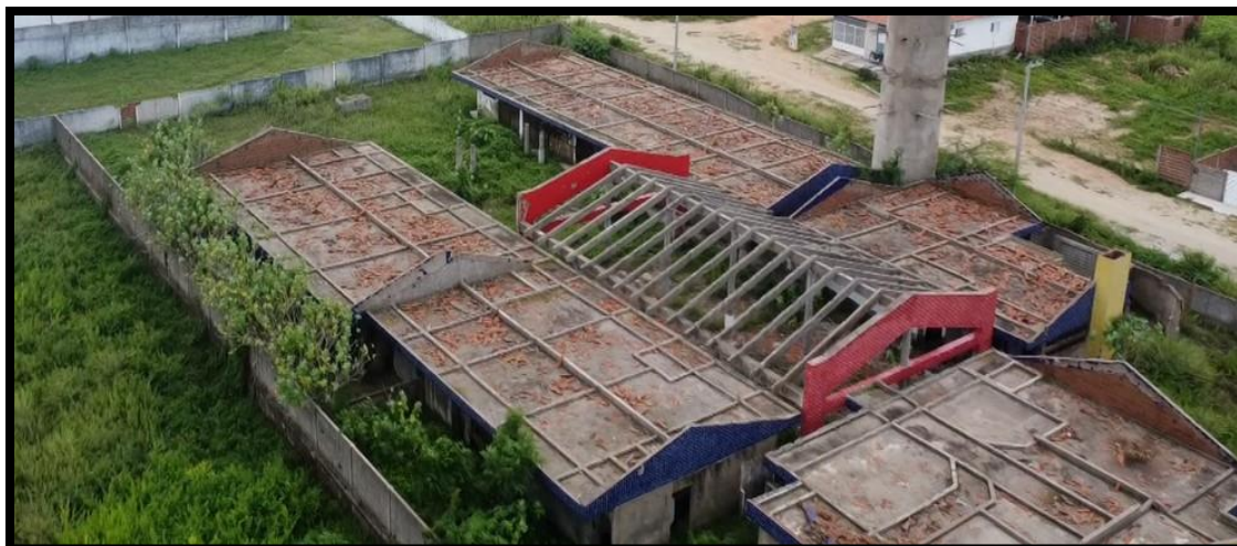
Condado (Sertão da Paraíba), Creche Tipo B, conveniada há 16 anos. Situação: com 75% de execução, foi abandonada e saqueada.
