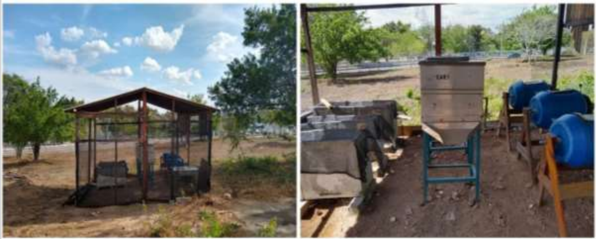
Figura 4. Sistema de tratamento aeróbio de resíduos sólidos orgânicos gerados em condomínio residencial. Campina Grande – PB.
