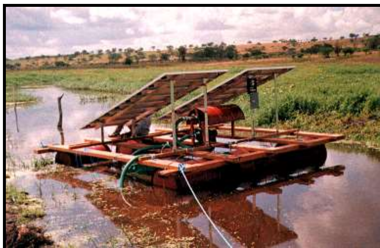
Foto 3 - Sistema de bombeamento para irrigação em Capim Grosso (BA)
