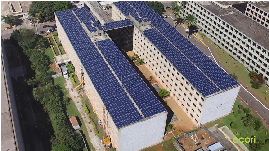
Figura 13 – Sistema FV zero grid instalado no prédio do Ministério da Defesa.
