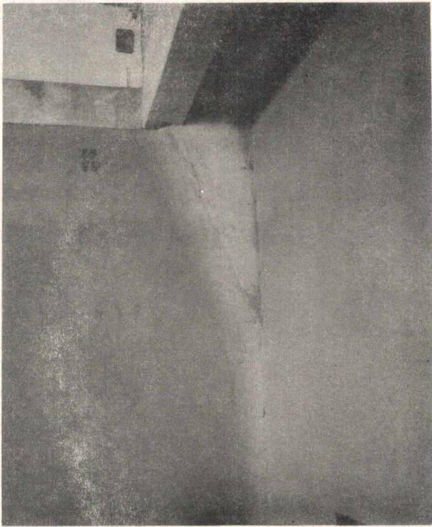
FIGURA 1 - Detalhe de acabamento de cantos em armazém de cacau. Note-se bo leado dos cantos verticais, apenas.
