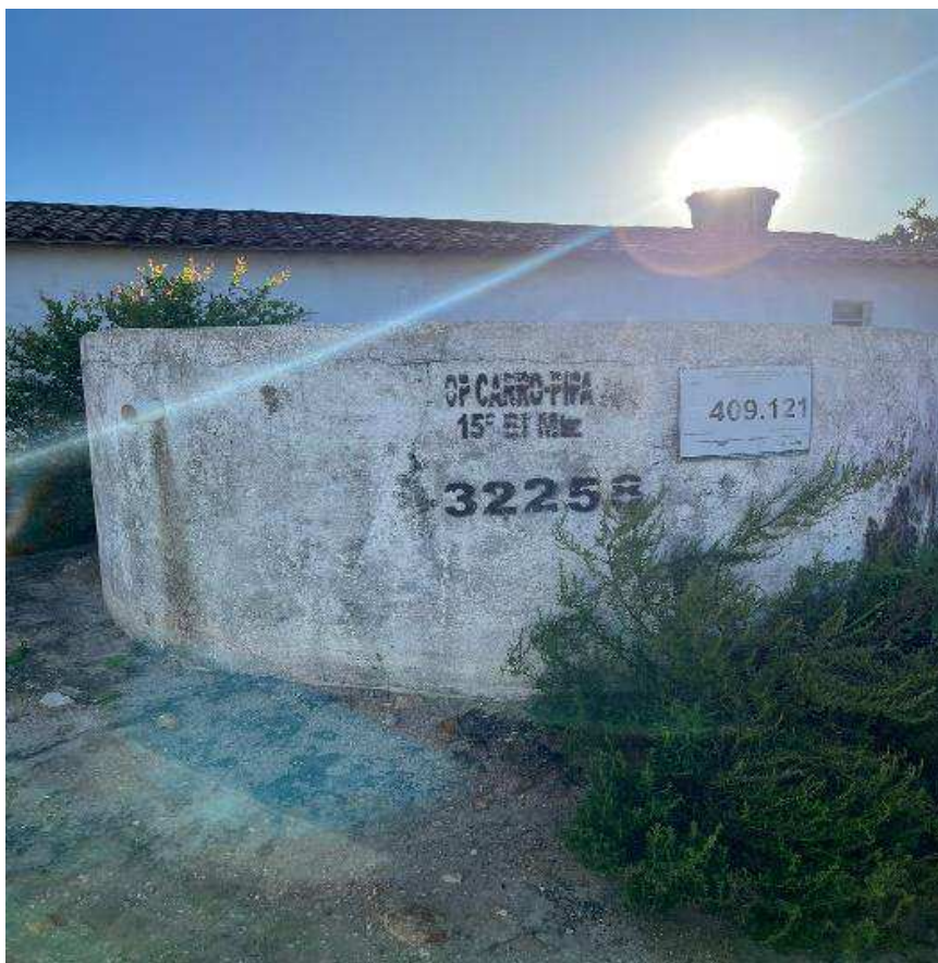
Figura 12: Cisterna operação carro-pipa na comunidade Chã da Tapioca
