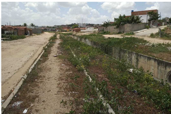
FIGURA 4 - OBRA DE PAVIMENTAÇÃO E AGENCIAMENTO ABANDONADA NA ZEIS RAMADINHA
