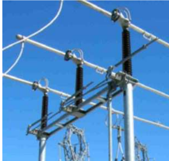
Figura 13 - Chave seccionadora de aterramento.
