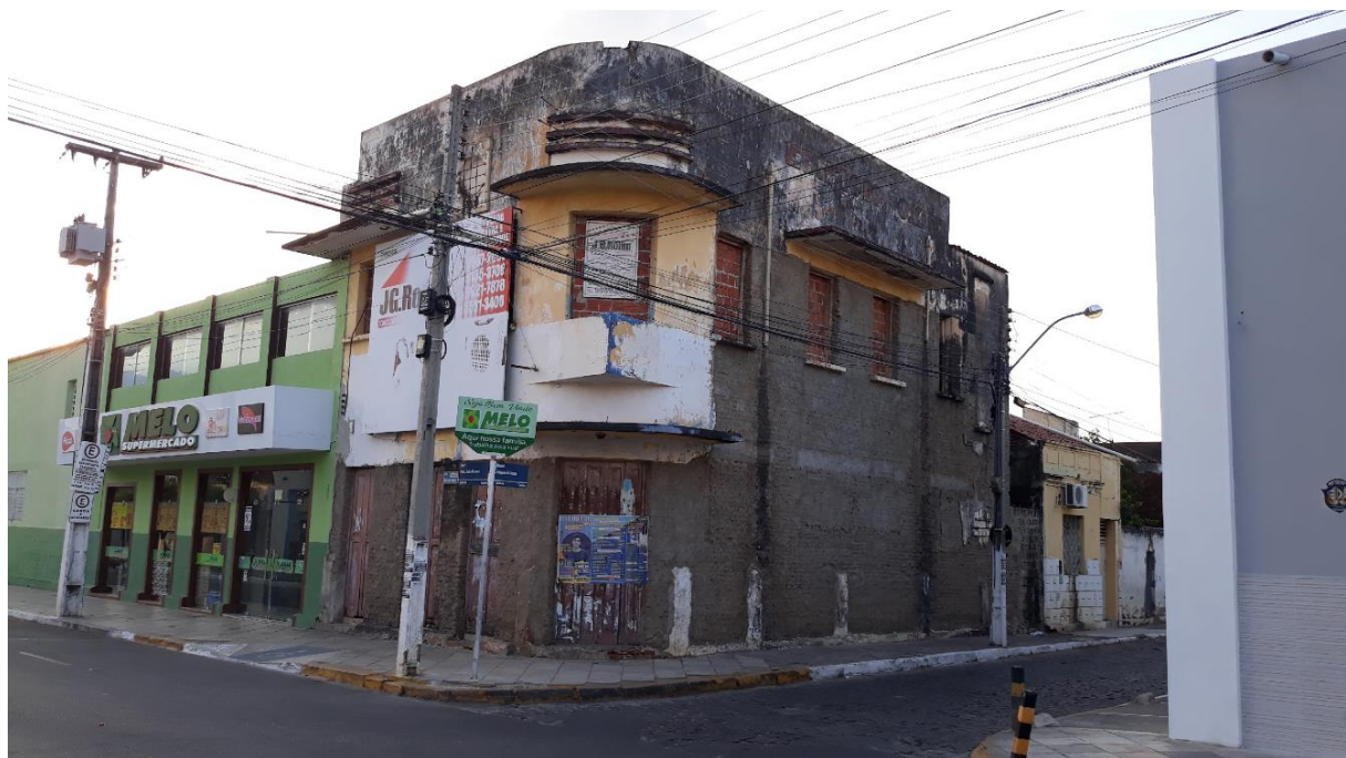
Imagem 2. Prédio do antigo Edifício OK , em estado de deterioração.
