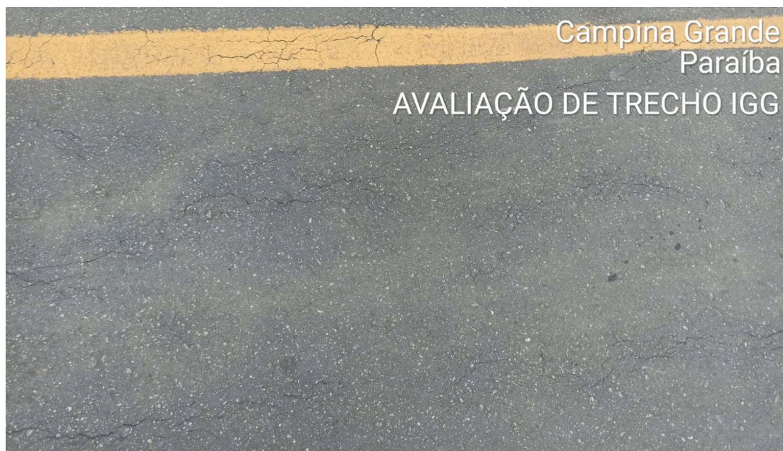
Figura 20 – Fissuras identificadas no pavimento estudado.
