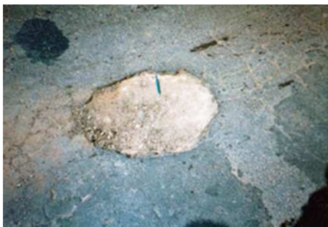
Figura 11 – Panela na superfície do pavimento.
