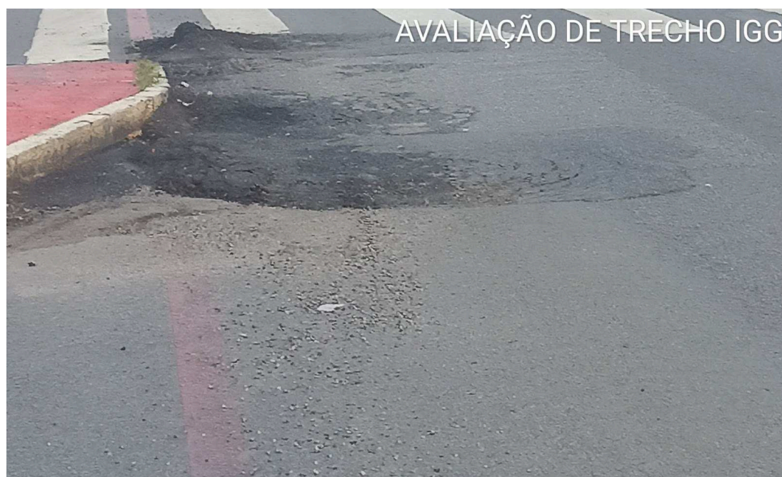
Figura 27 – Escorregamento identificado no pavimento estudado.
