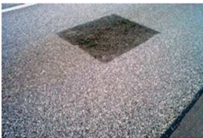
Figura 12 – Remendo na superfície do pavimento.
