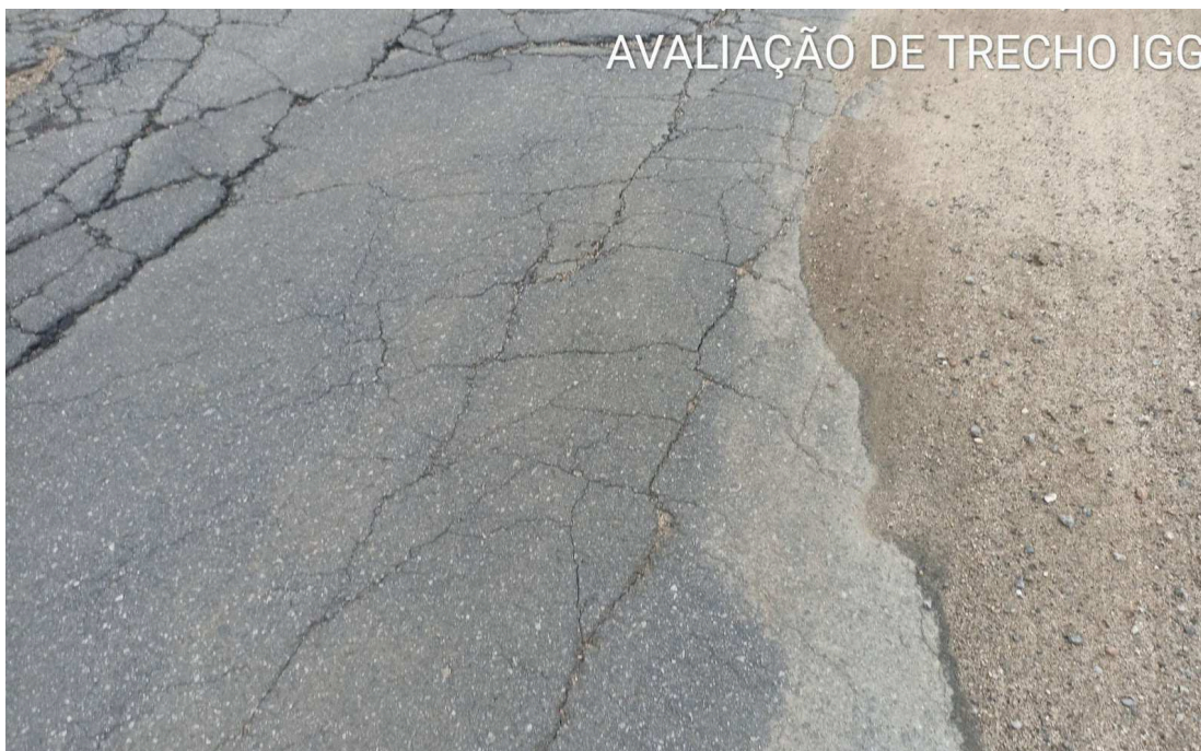
Figura 25 – Afundamento de consolidação local identificado no pavimento estudado.
