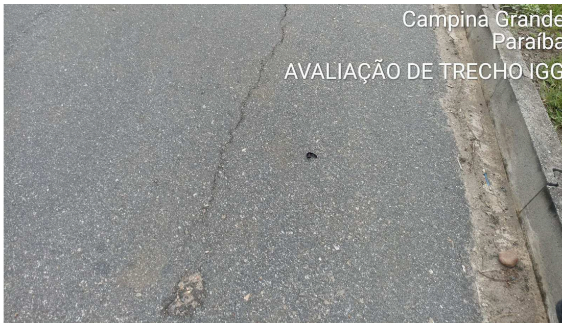
Figura 22 – Trincas longitudinais identificadas no pavimento estudado.
