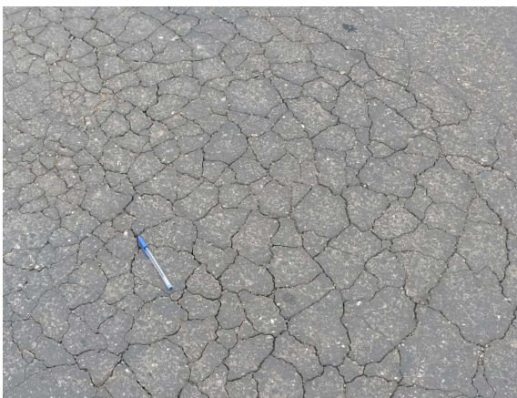
Figura 4 – Exemplo de fenda na superfície do pavimento.
