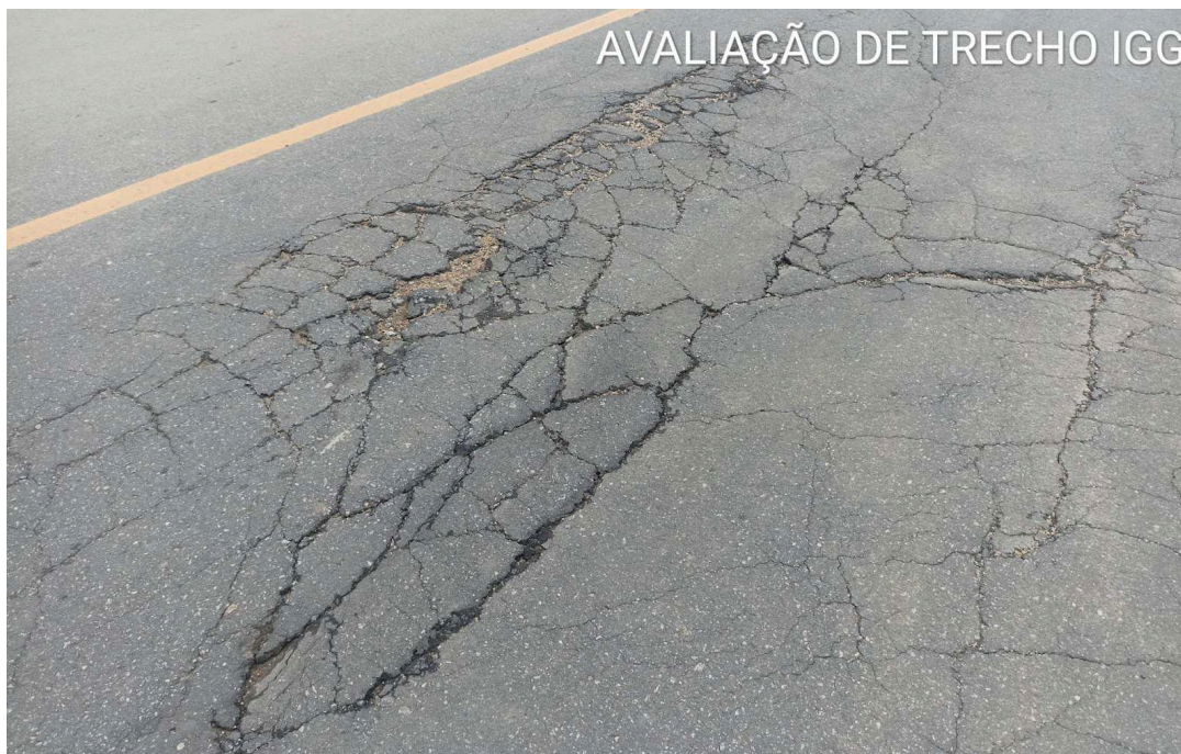
Figura 24 – Trincas tipo “bloco” identificadas no pavimento estudado.
