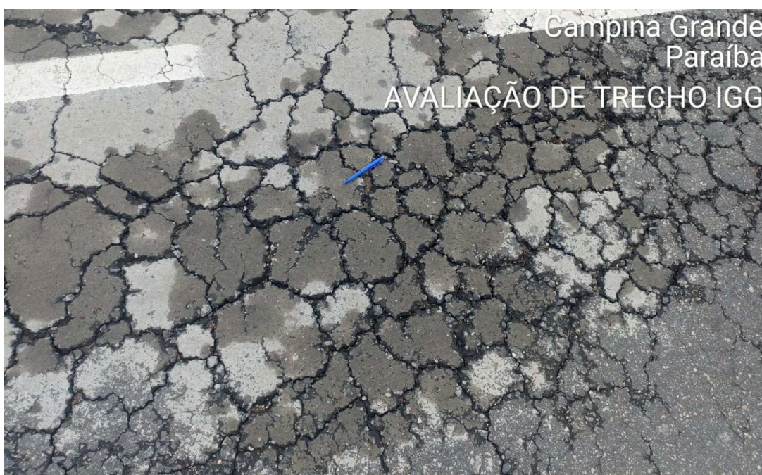
Figura 23 – Trincas tipo “couro de jacaré” identificadas no pavimento estudado.
