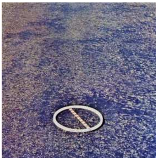
Figura 9 – Exsudação na superfície do pavimento.
