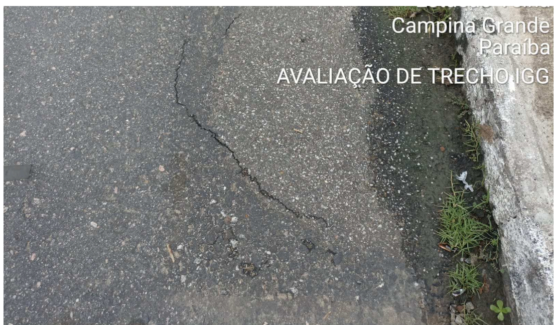
Figura 21 – Trincas transversais identificadas no pavimento estudado.
