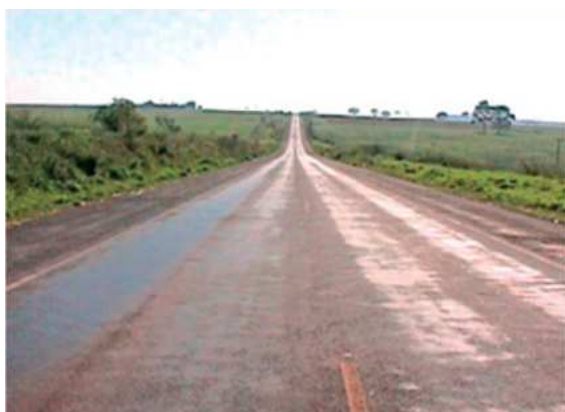
Figura 6 – Exemplo de afundamento na superfície do pavimento.
