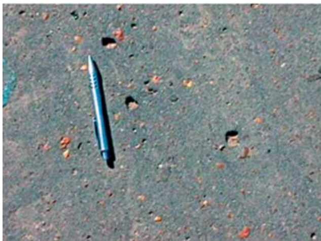
Figura 10 – Desgaste na superfície do pavimento.
