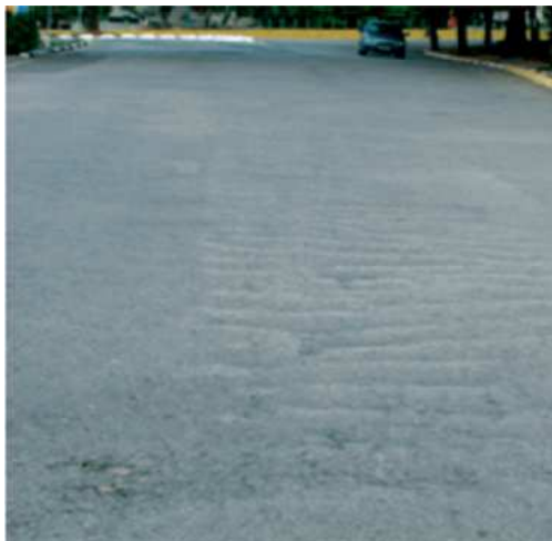
Figura 8 – Ondulações na superfície do pavimento.
