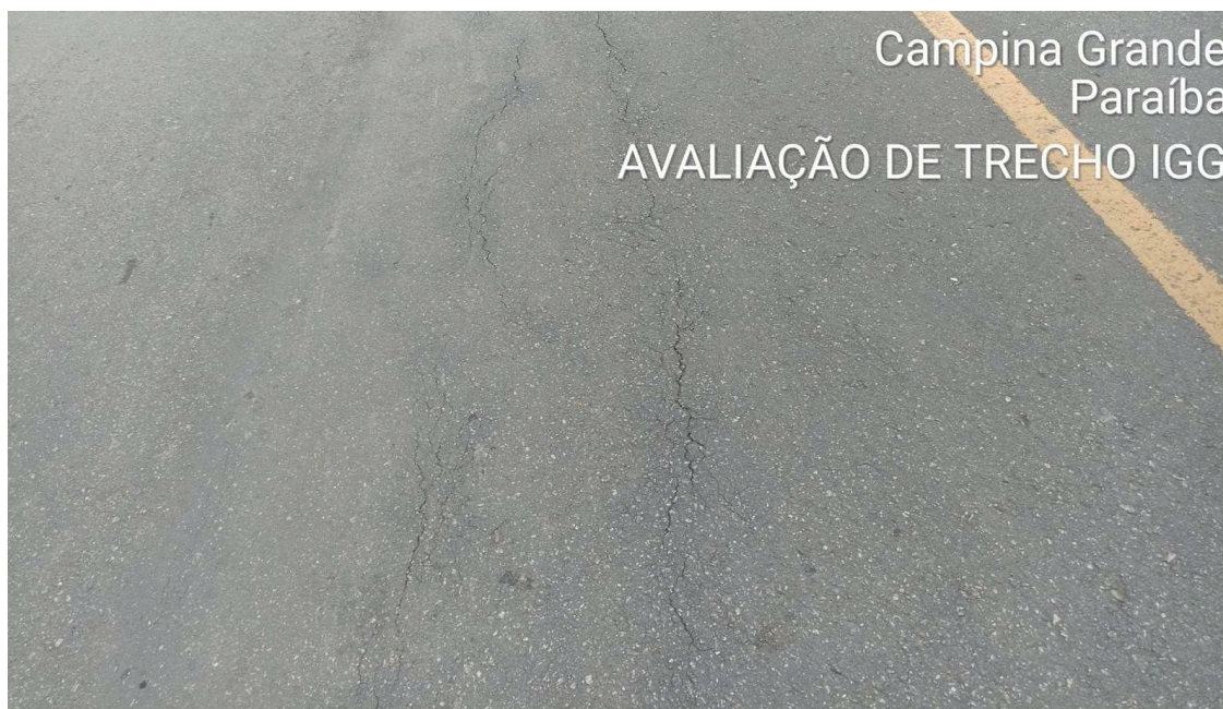
Figura 26 – Ondulação identificada no pavimento estudado.
