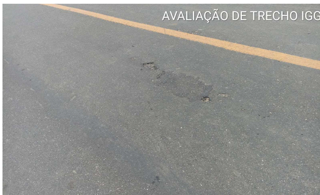
Figura 30 – Desgaste identificado no pavimento estudado.
