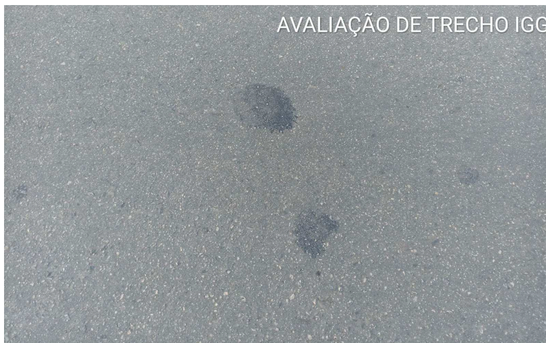
Figura 28 – Exsudação identificada no pavimento estudado.
