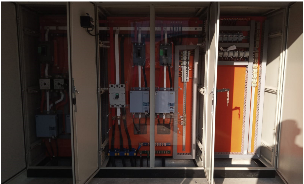
Figura 17 – Imagem do quadro completo instalado na Matuta.
