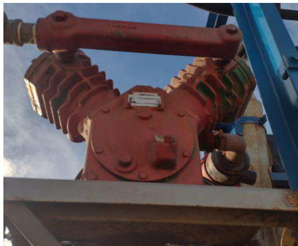
Figura 31 – Compressor de ar.
