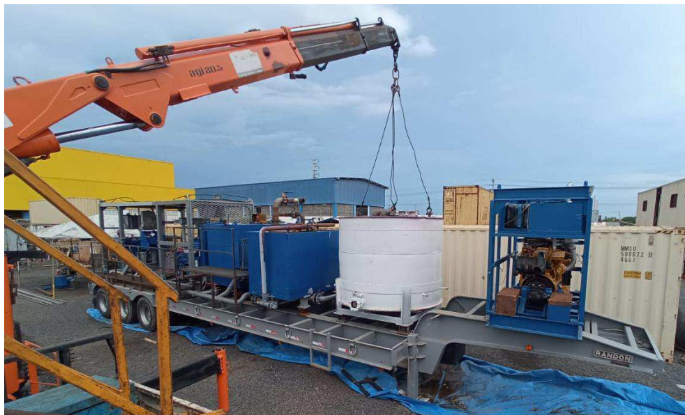
Figura 15 – Posicionamento final dos equipamentos sobre a prancha.
