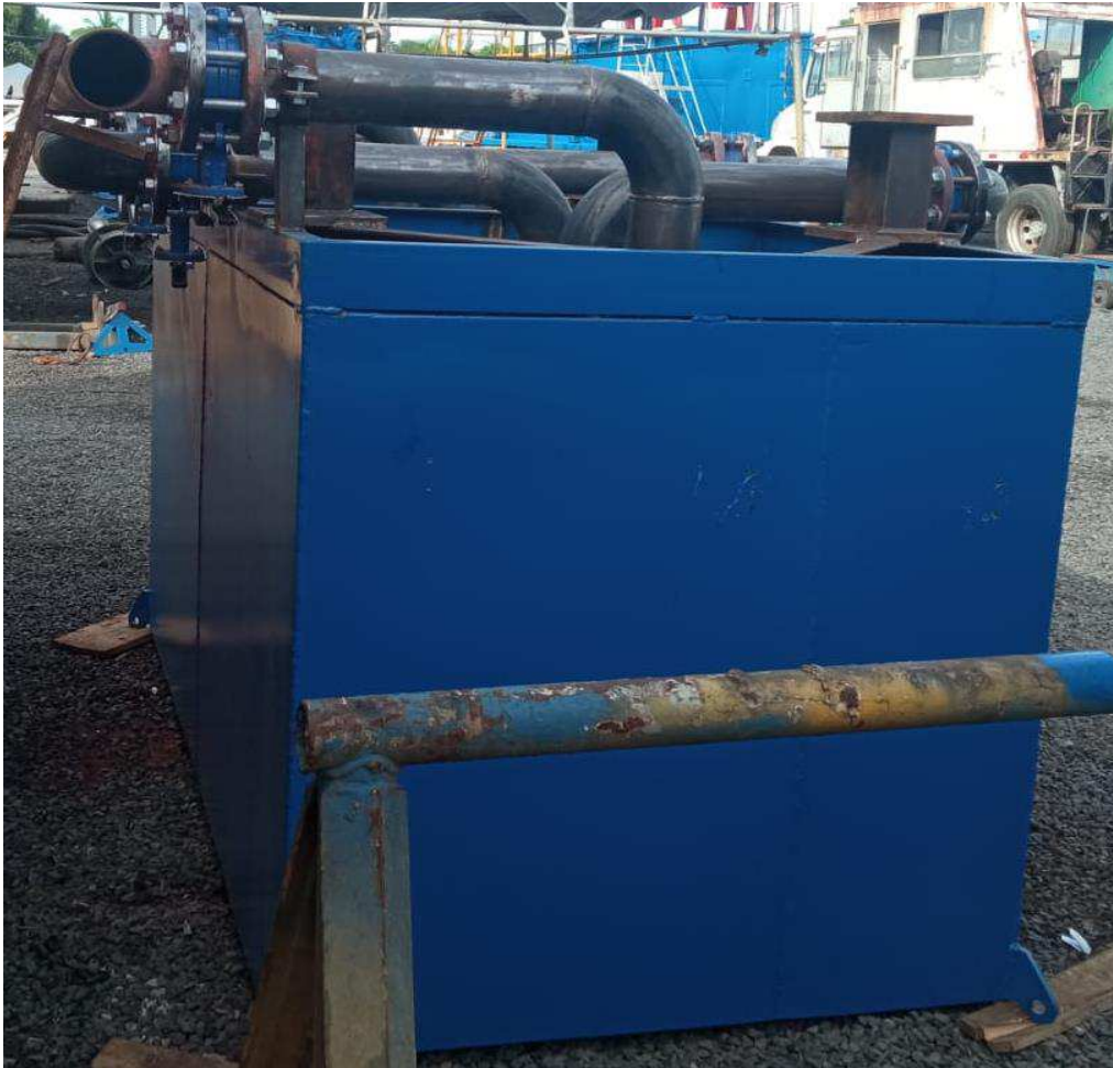
Figura 27 - Tanque de Deslocamento
