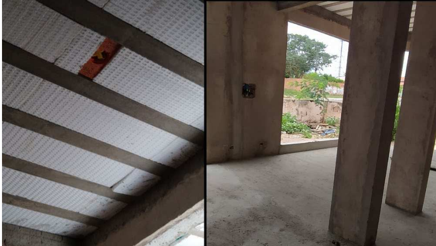
Figura 18 – Registros da obra: caixas octogonais com suporte para lajotas e quadro de distribuição na unidade Drogaria (Térreo).
