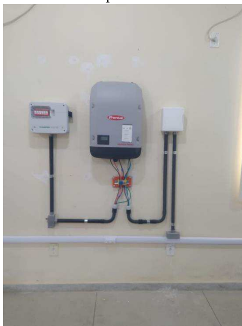
Figura 05: Inversor de frequência instalado no LSP.
