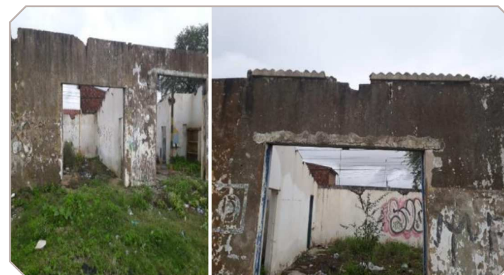
IMAGEM 17 - ATUAL ESTADO DE CONSERVAÇÃO DA OFICINA DE MANUTENÇÃO
