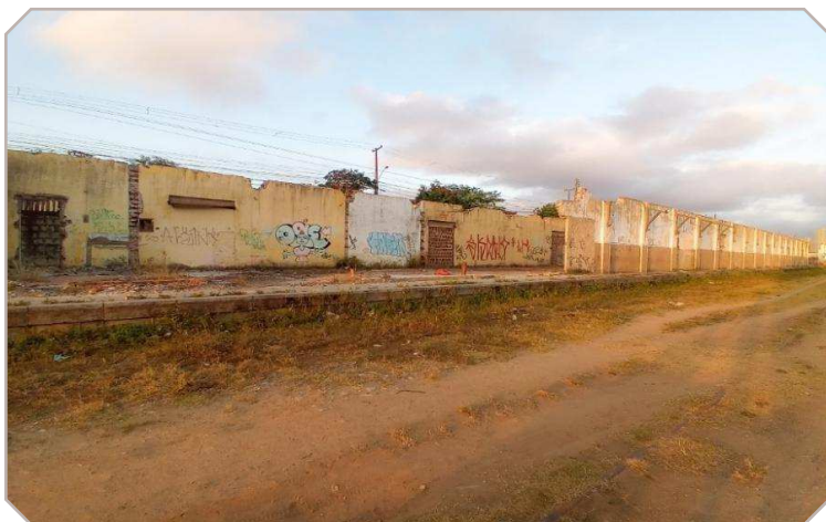
IMAGEM 16 - GALPÃO DE FERRAMENTAS EM AVANÇADO ESTADO DE DEGRADAÇÃO
