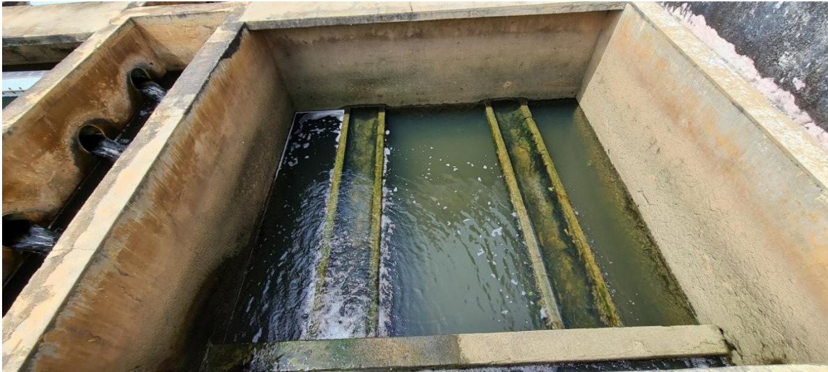
Figura 17 - Filtros da ETA de Pombal
