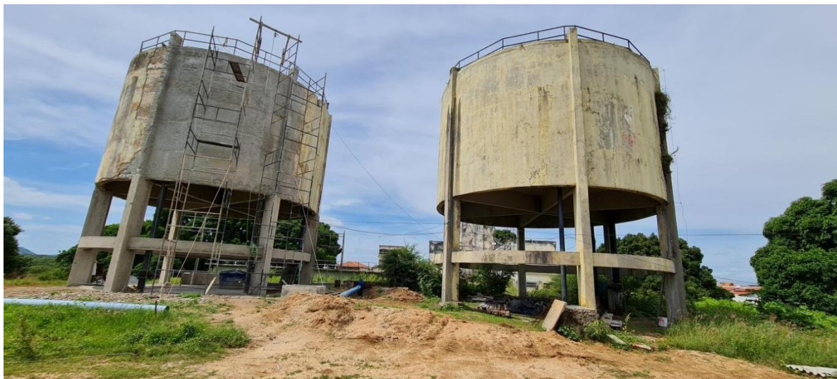
Figura 24 - Reservatórios Elevados 01 e 02 - REV1 e REV2
