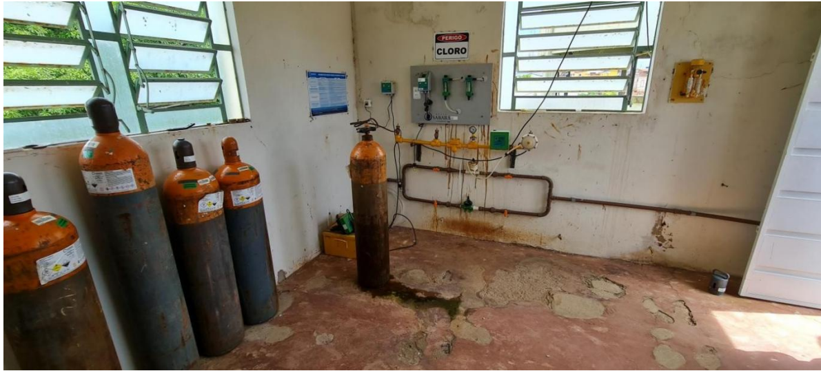
Figura 18 - Armazenagem de cloro e clorador da ETA de Pombal
