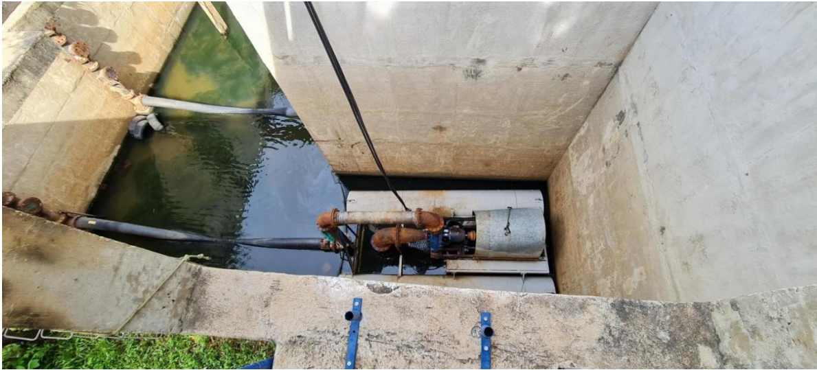
Figura 11 - Conjunto Flutuante na Captação de água do SAA de Pombal
