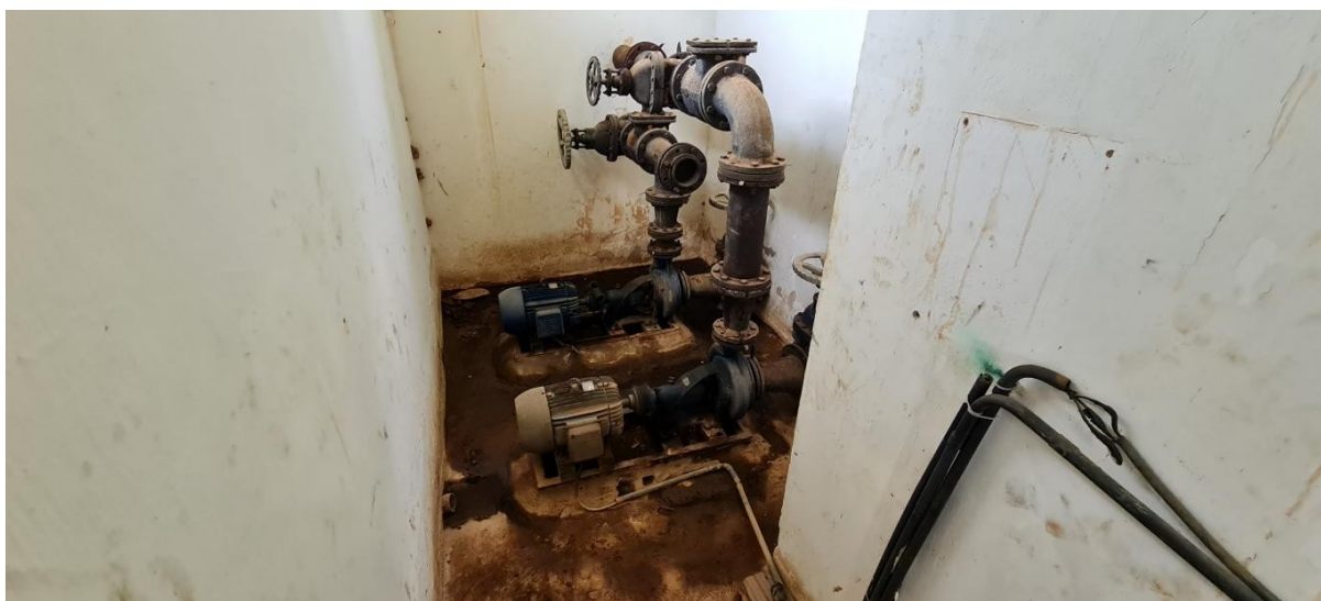
Figura 21- Elevatória de água tratada da ETA de Pombal
