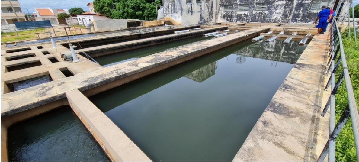
Figura 16 - Decantadores da ETA de Pombal
