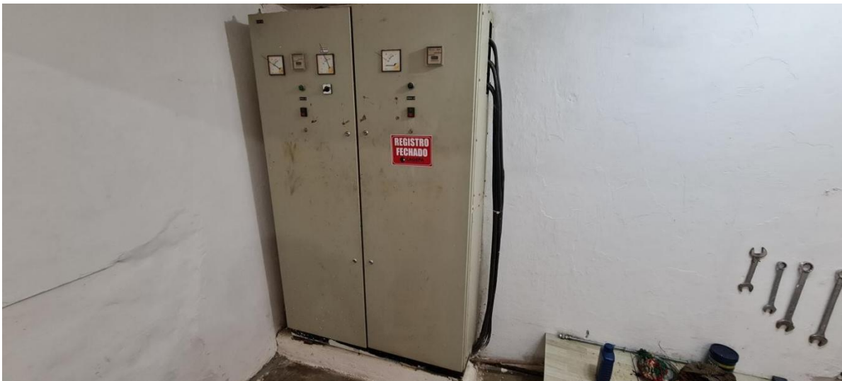
Figura 12 - Quadro de Comando da Estação Elevatória de Água Bruta
