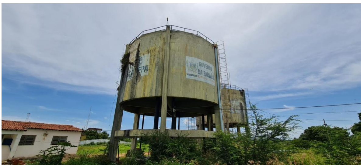
Figura 23 - Reservatório Elevado 02 - REV2
