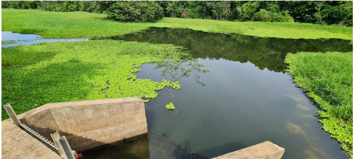
Figura 9 - Canal de aproximação da Captação de água do SAA de Pombal
