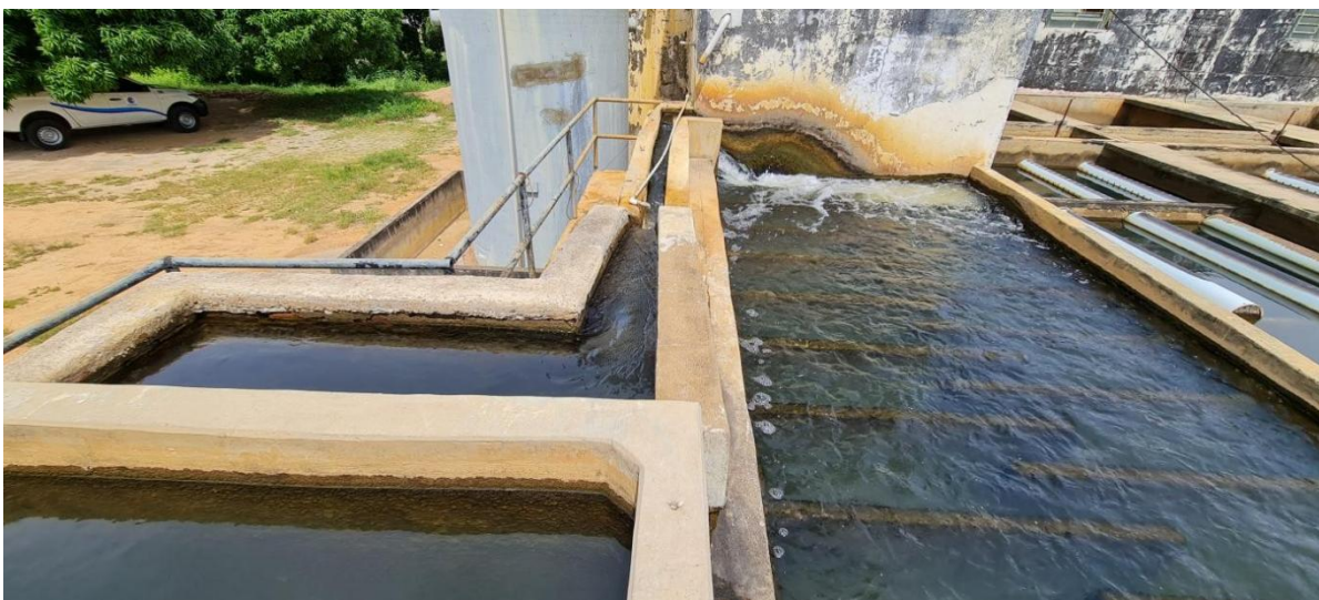
Figura 13 - Poço de chegada e calha Parshall da ETA de Pombal
