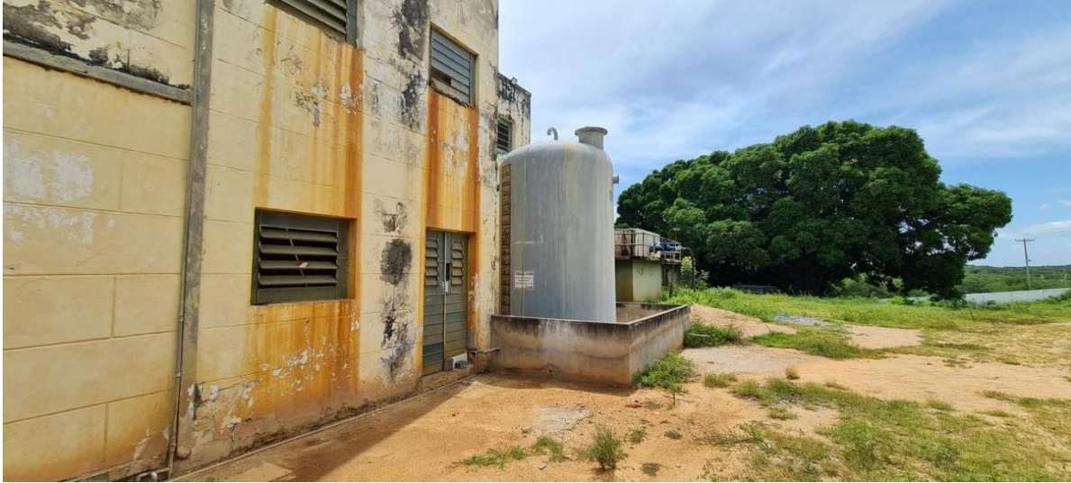
Figura 14 - Armazenamento de coagulante
