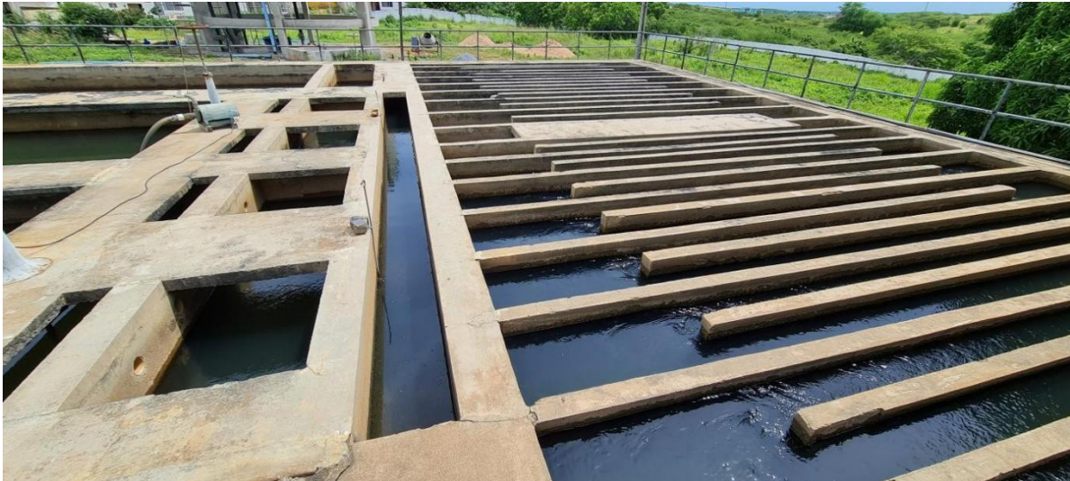
Figura 15 - Floculadores da ETA de Pombal
