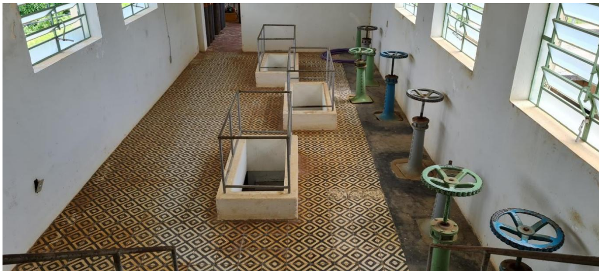
Figura 19 - Comandos dos registros de operação da ETA de Pombal
